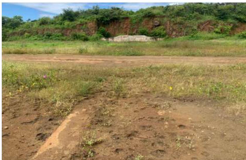
Imagem 04: Vertedouro com necessidade de limpeza e desobstrução.
