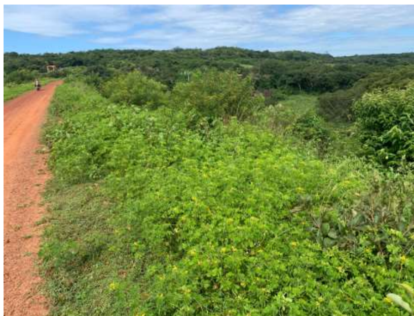
Imagem 02: Vegetação excessiva no talude de jusante.
