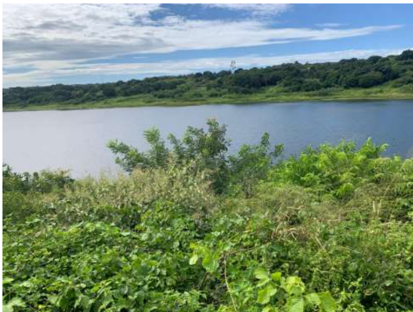
Imagem 05: Presença de vegetação junto às estruturas hidráulicas.
