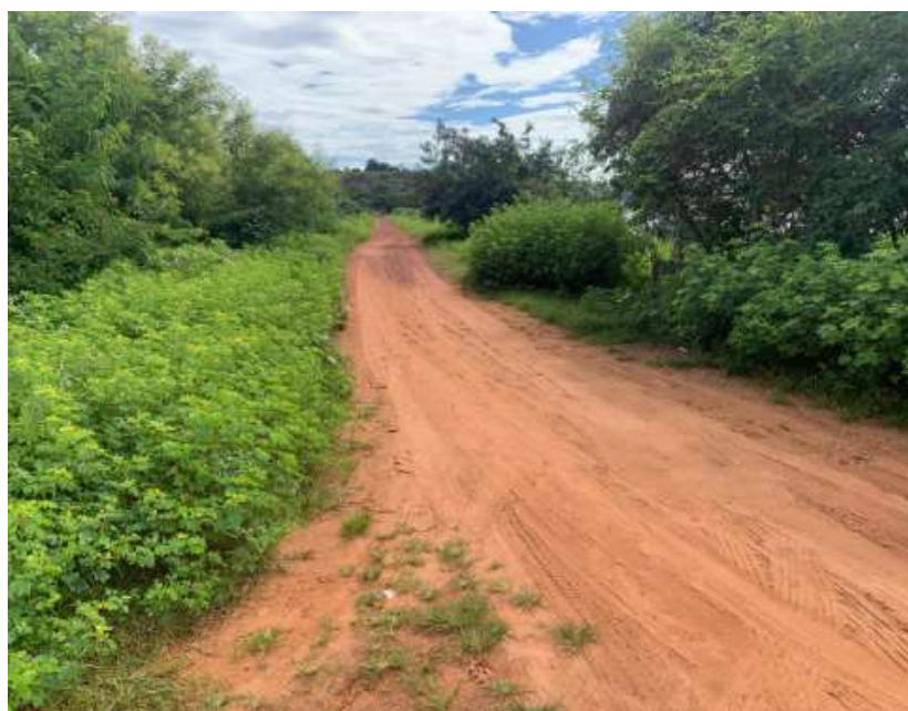
Imagem 03: Vegetação invasiva sobre o coroamento da barragem.
