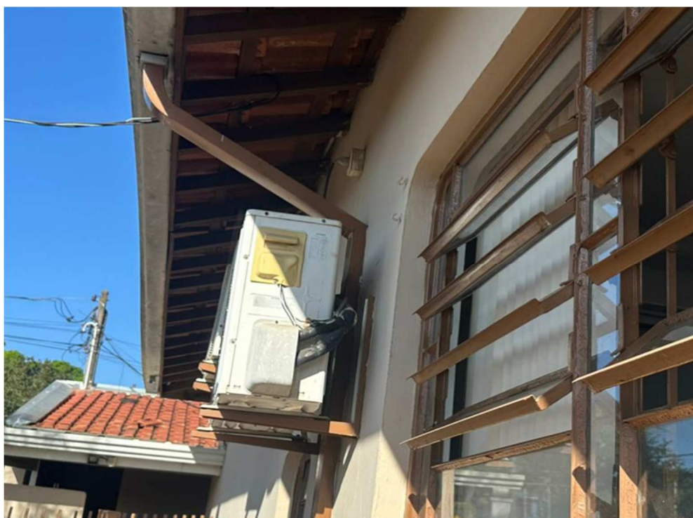
Figura 5 - Aparelho de Ar-condicionado do gabinete 7 ligado com uma tomada externa.
