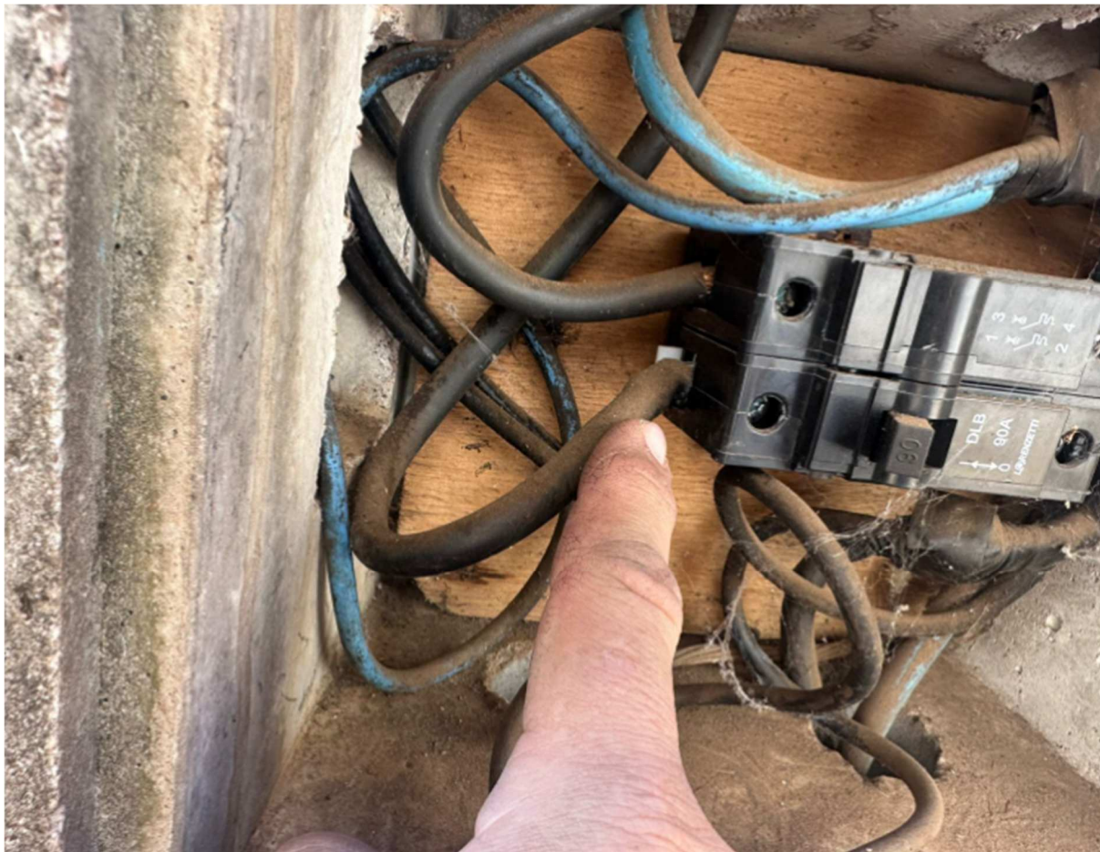
Figura 3 - Indicação de Sobreaquecimento dos cabos no padrão B1.
