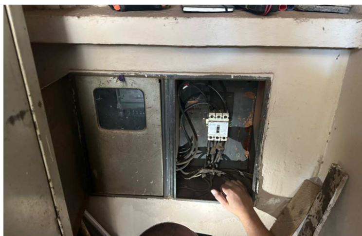
Figura 1 - Padrão C1 instalado.
