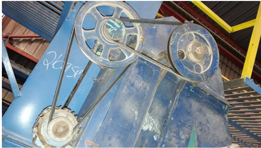
Figura 3 — Polias, correias e eixos expostos em equipamentos da UBS. Referência do tipo de ponto que deve permanecer bloqueado e sinalizado durante todo o desmanche (NR-12).
