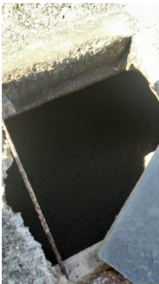
Figura 3 – interior da caixa de gordura do restaurante, com resíduo acumulado próximo à boca da caixa — 26/08/2026.
