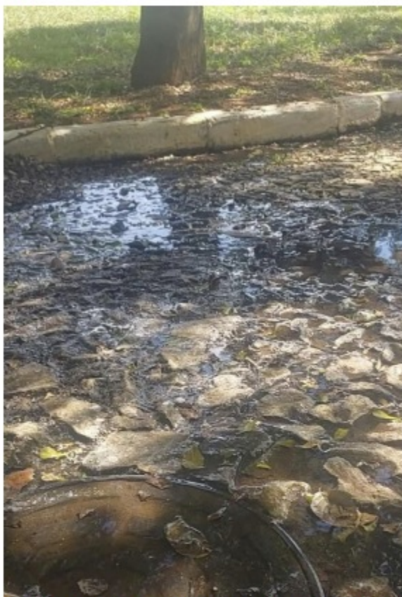
Figura 1 – transbordamento de efluente sobre o piso de pedra, nas proximidades do poço de visita (PV) — 26/08/2026.
