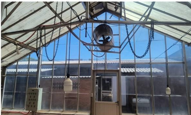
Figura 05 – Compartmento 01 – foto interna – detalhe de parede de vidro (frontal), sistema de abertura do lanternins e sistema de aquecimento.
