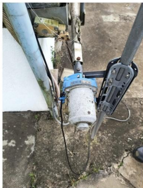
Figura 22 – detalhe do motor de redução do sistema de resfriamento.
