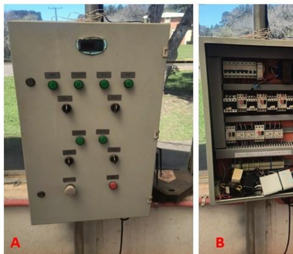
Figura 31 (A e B)– Painel de controle do compartimento 04.
