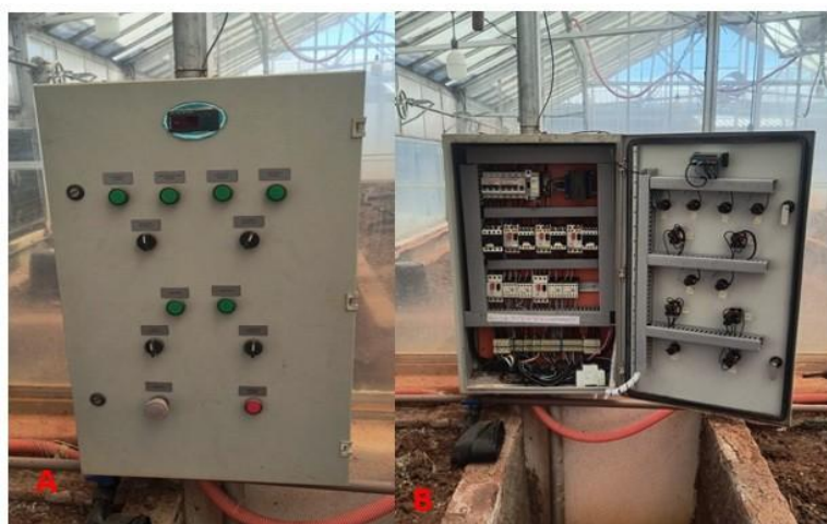
Figura 30 (A e B)– Painel de controle do compartimento 03.
