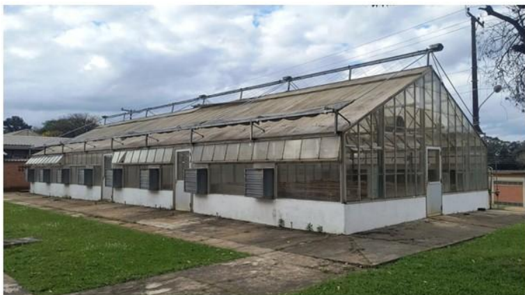
Figura 1 – Lateral esquerda - com exaustores, cobertura e sistema de sombreamento
