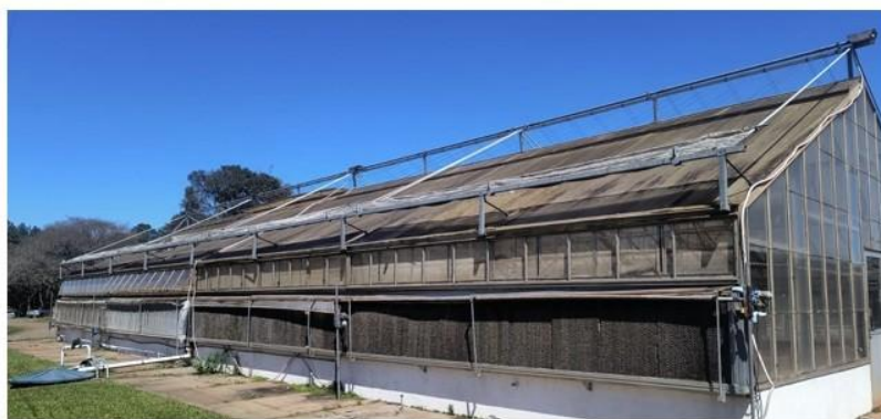
Figura 25 – Casa de vegetação 2 – detalhe do sistema de resfriamento.
