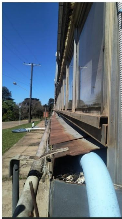
Figura 27 – Casa de vegetação 2 – chapas de proteção do sistema de resfriamento (b).
