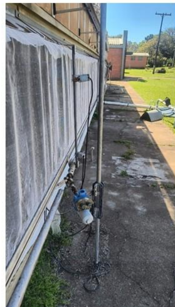
Figura 24 – detalhe sistema de abertura e fecho proteção do sistema de resfriamento (total de 4 cada compartimento da casa de vegetação).
