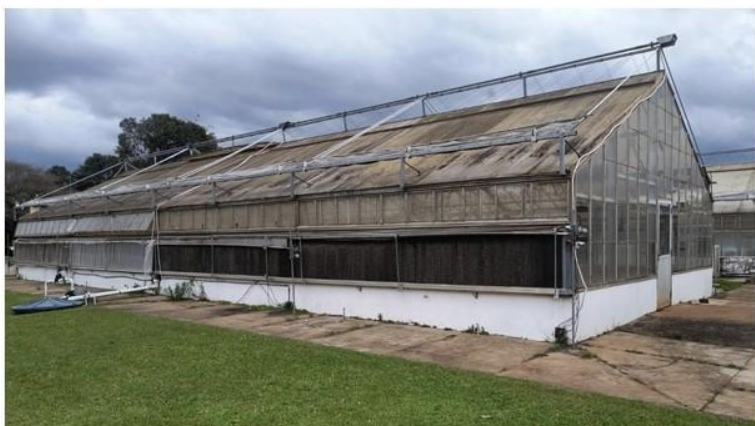
Figura 2 – Lateral direita com detalhe para os painéis evaporativos, cobertura e sistema de sombreamento
