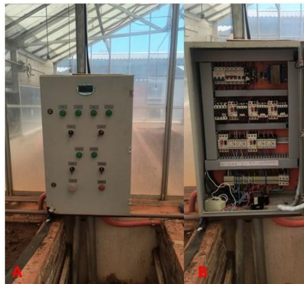
Figura 29 (A e B) – Painel de controle do compartimento 02.
