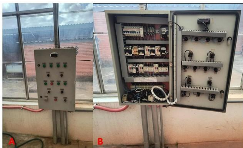
Figura 28 (A e B) – Painel de controle do compartimento 01.
