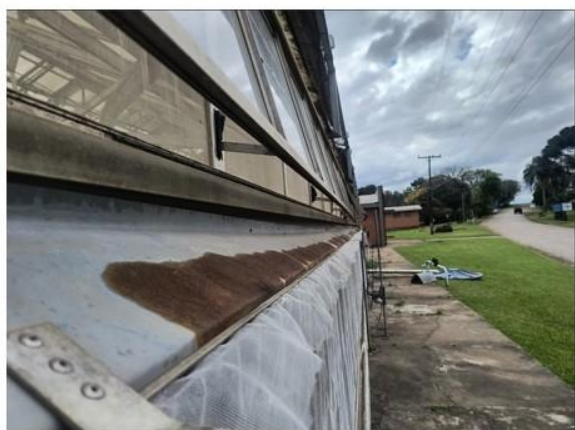
Figura 26 – Casa de vegetação 2 – chapas de proteção do sistema de resfriamento (a).
