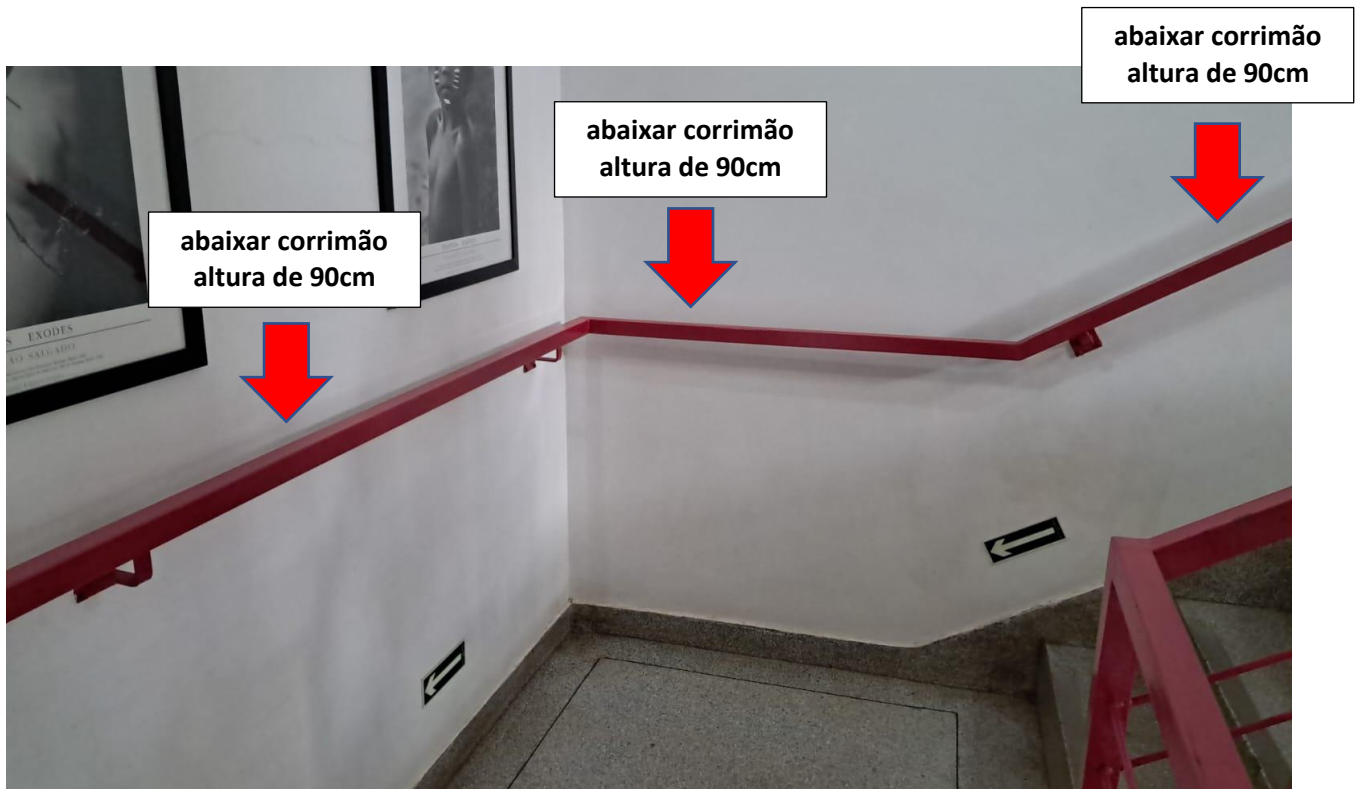
Corrimão existente (a 100 cm), para abaixar a 90 cm.
