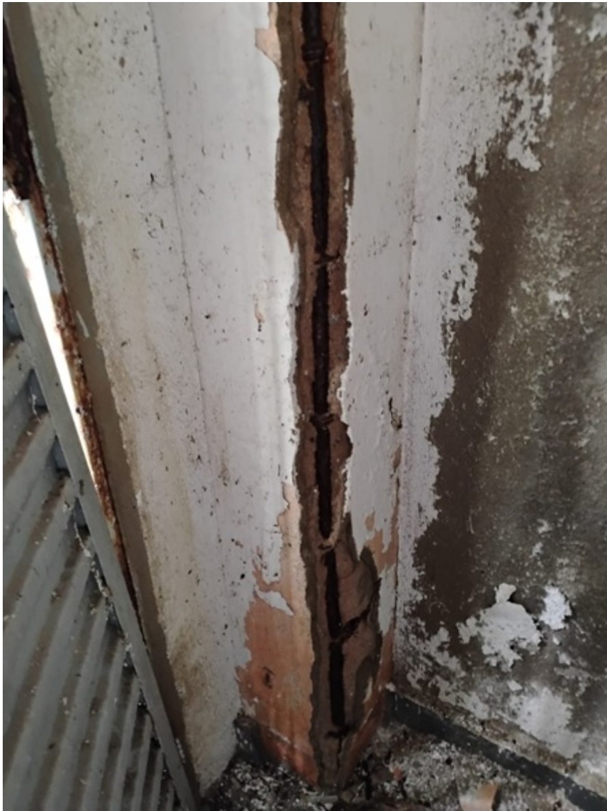
Vistas da estrutura e patologias
