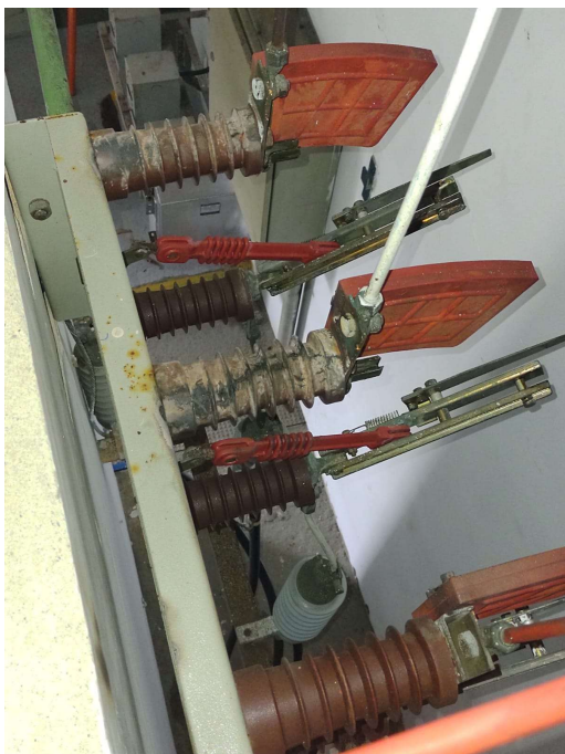
Figura 5: Ponto de deteriorização do isolador
