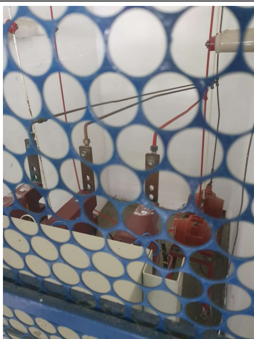
Figura 11: TC de medição para o disjuntor de Média Tensão.
