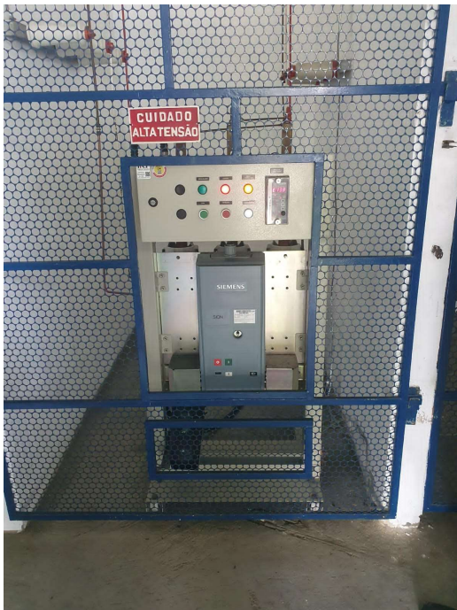
Figura 9: Disjuntor de Média tensão.
