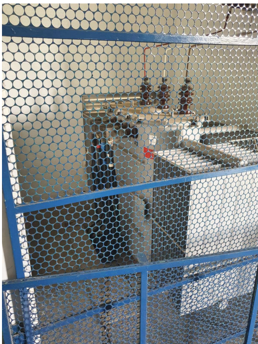
Figura 7: Transformador de 500 kVA
