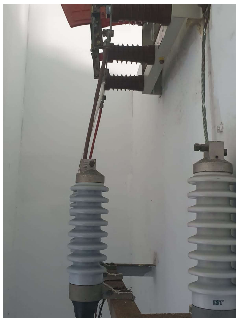
Figura 6: Conexão com Isoladores
