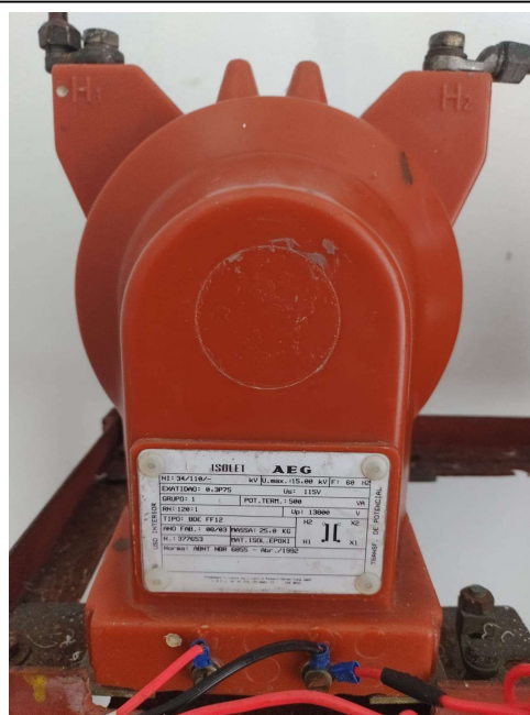
Figura 14: Transformador de potencial tipo BDE FF12
