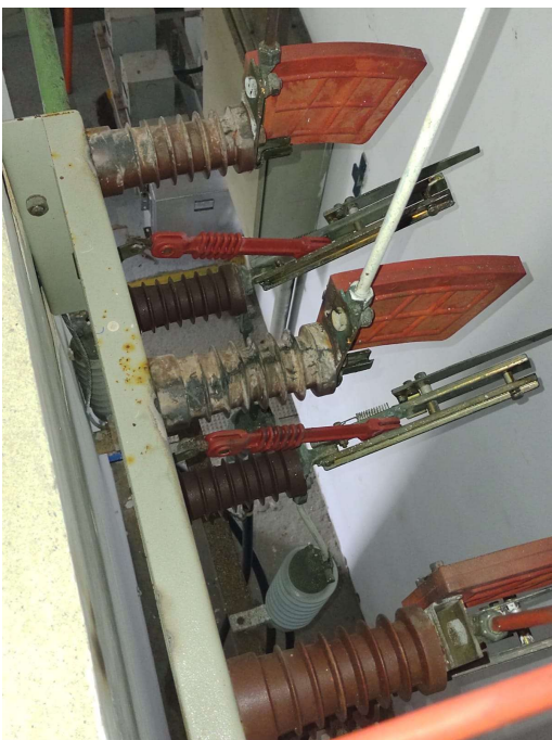
Figura 5: Ponto de deteriorização do isolador
