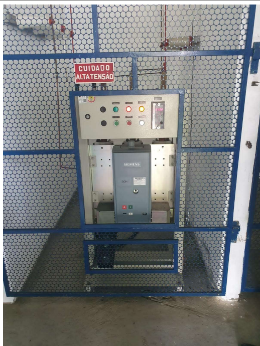
Figura 9: Disjuntor de Média tensão.
