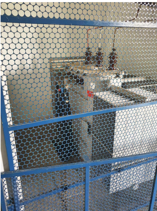
Figura 7: Transformador de 500 kVA
