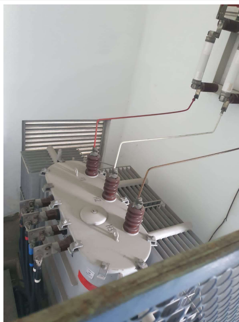
Figura 8: Transformador de 500 kVA
