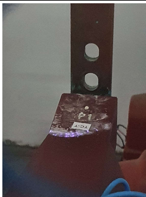
Figura 12: TC de medição para o disjuntor de Média Tensão.
