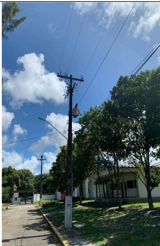
Imagem 7: Transformador de 45 kVA da SPROT.
