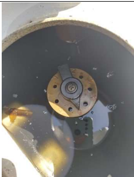
Imagem 9: Transformador 45 kVA da SPROT, alteração na viscosidade do óleo, indica aquecimento do enrolamento.
