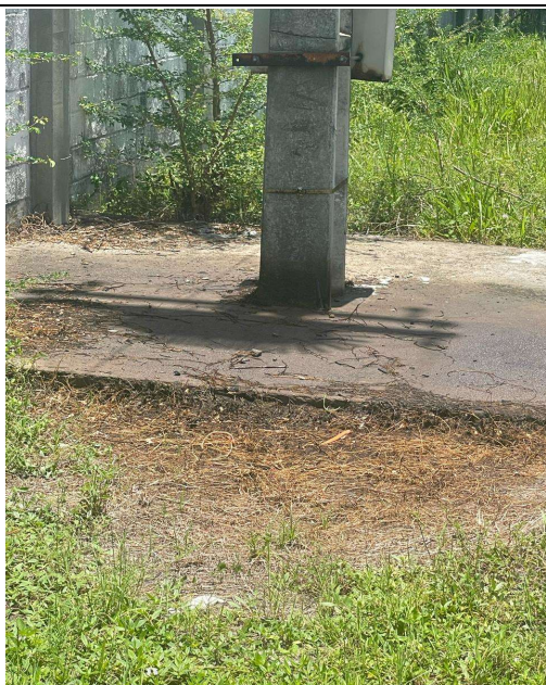
Imagem 5: Registro de vazamento do óleo isolante no solo, localizado em baixo do transformador da DRH-3/ASO.
