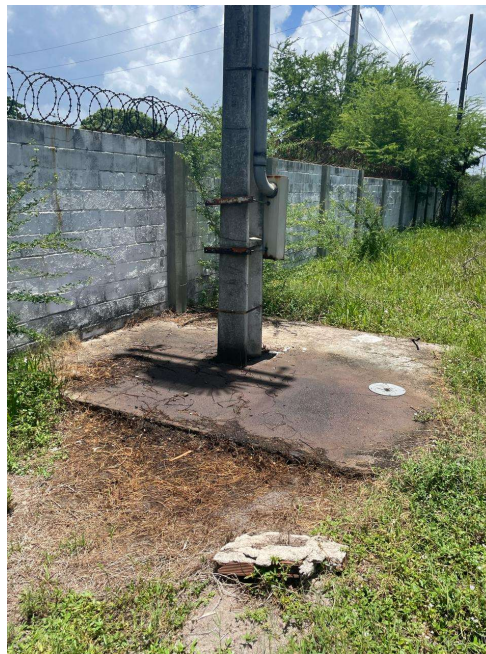
Imagem 6: Quadro de distribuição de energia com sinais de corrosão necessitando substituição.
