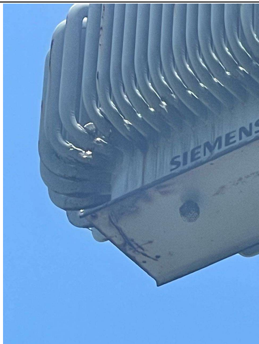
Imagem 3: Pontos de corrosão na parte inferior do Transformador DRH-3/ASO e indicação de vazamento de óleo isolante.
