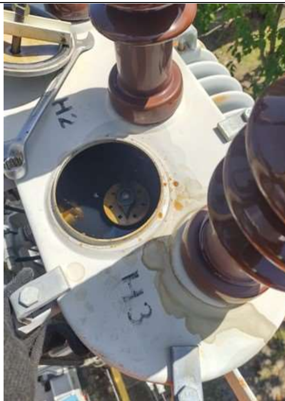
Imagem 8: Transformador 45 kVA da SPROT.
