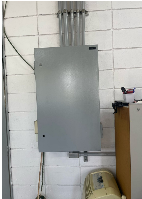
FOTO 2 – Ausência de sinalização de emergência do tipo “quadro elétrico” e equipamento obstruindo o quadro.
