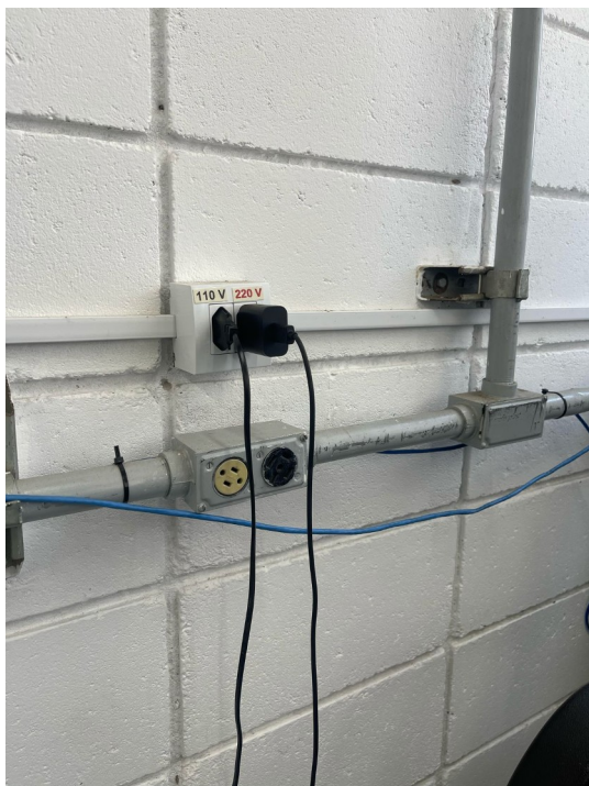
FOTO 3 – Instalações elétricas em boas condições.
