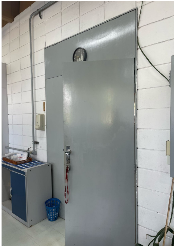
FOTO 1 – Ausência de sinalização de emergência do tipo “saída”.
