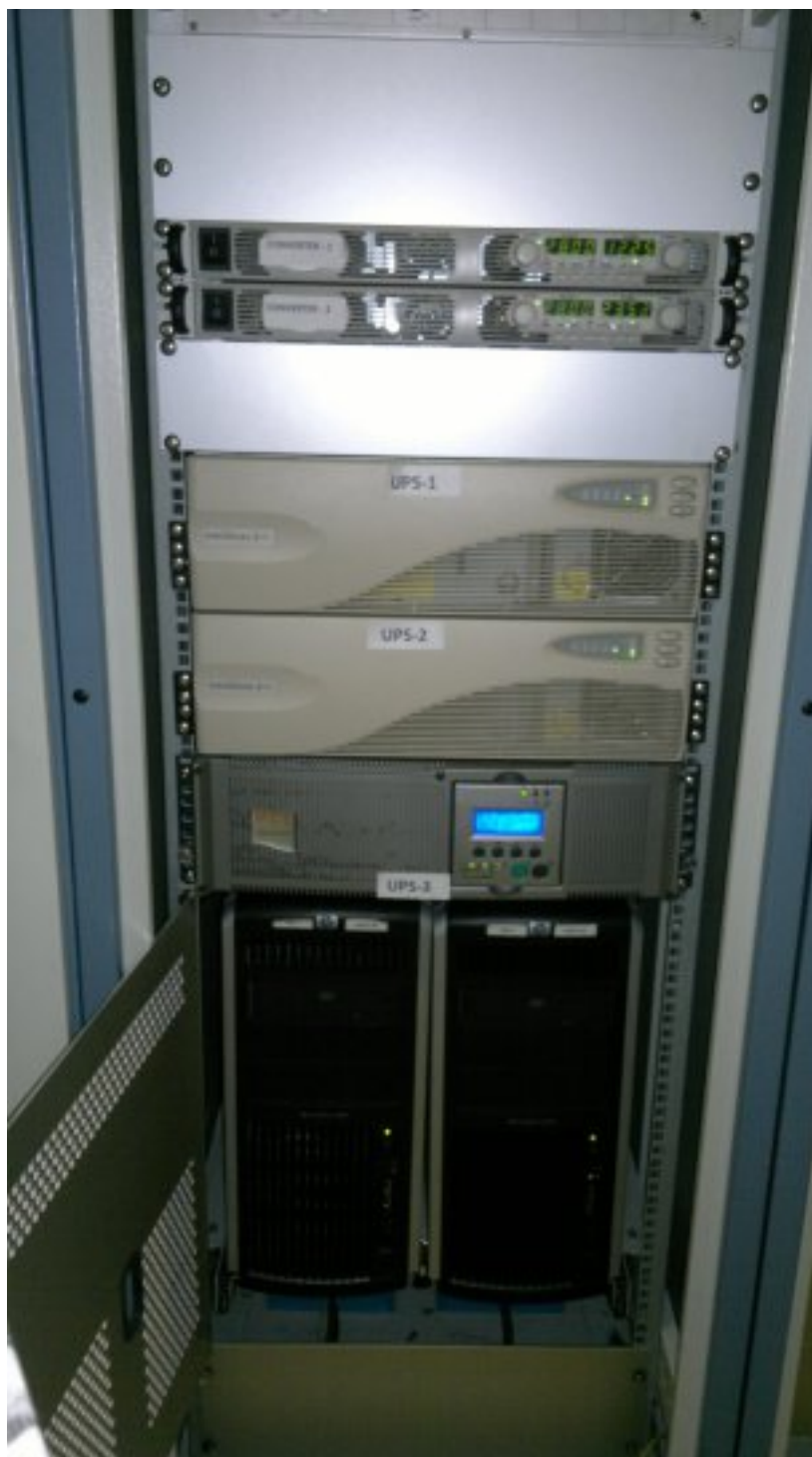
Figura 4 – Sistema de UPS e Servidores (TMP#1 e TMP#2)
