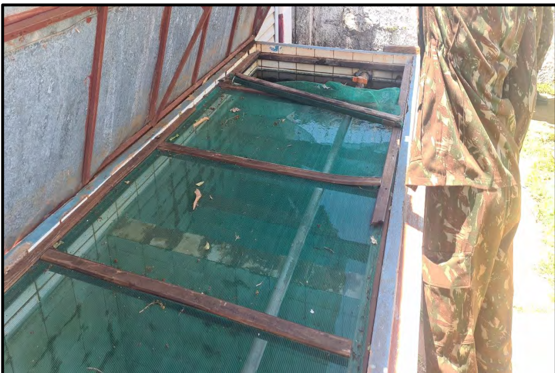
Figura 2 – Decantador utilizado no Sistema de Abastecimento de Água
