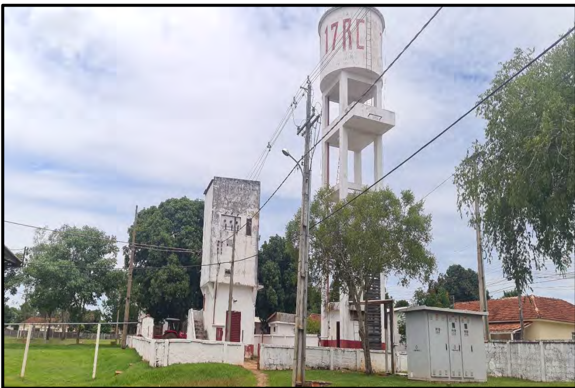
Figura 3 – Reservatório Elevado com capacidade de 51 m 3 .
