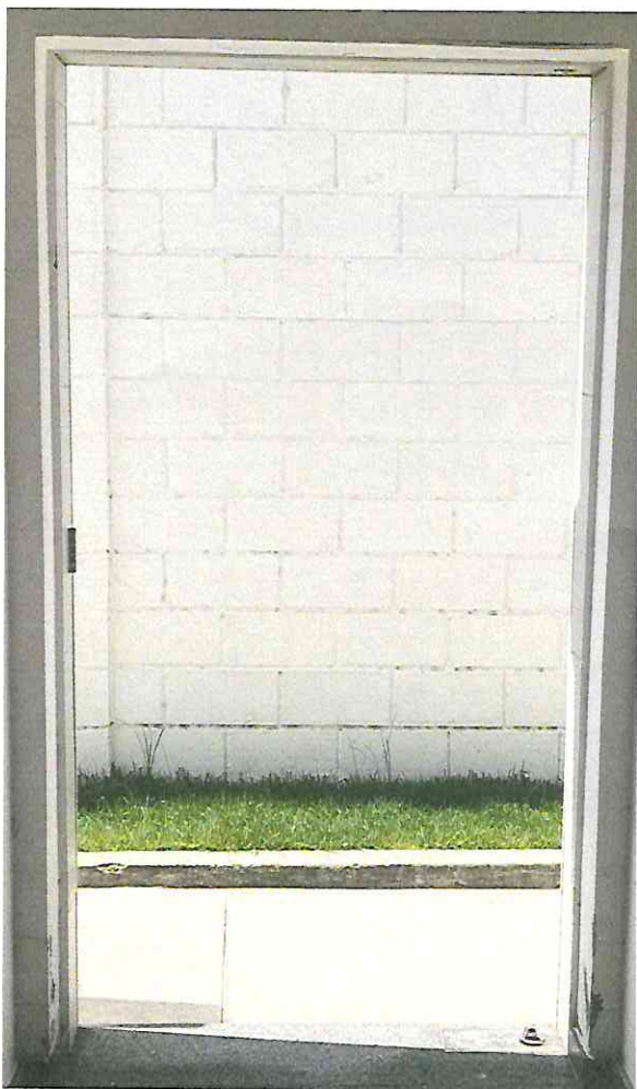
Fotografia 3 – Fotografia do vão de passagem.
