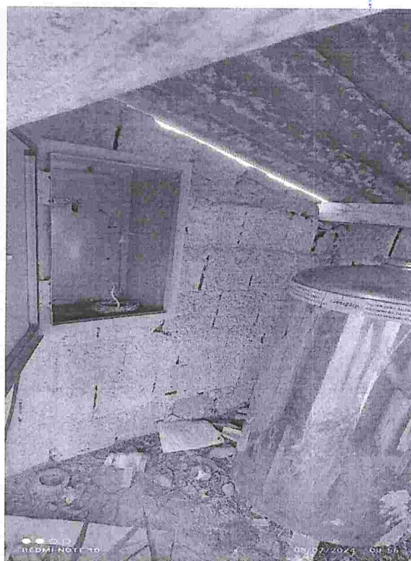
Foto 7: Clorador Caixa D'Água "2" de 60 mil litros.
