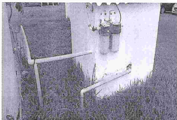
Foto 4: Clorador Caixa D'Água "1" de 60 mil litros.
