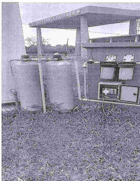
Foto 8: Clorador Caixa D'Água de 15 mil litros.
