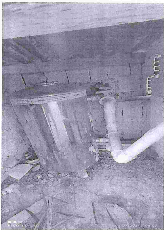
Foto 6: Clorador Caixa D'Água "2" de 60 mil litros.
