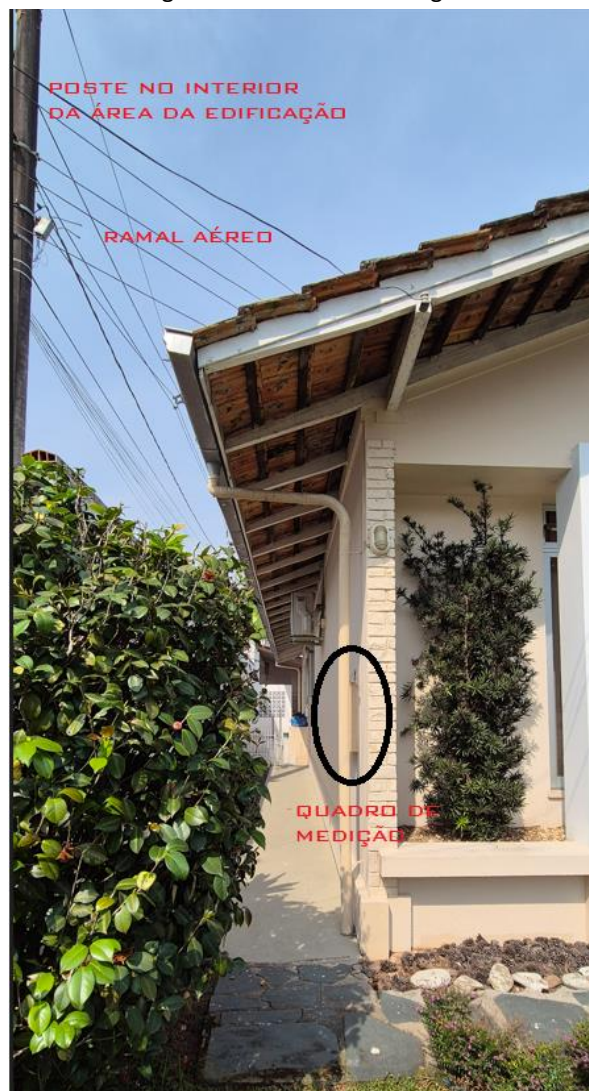
Figura 11: Entrada de Energia
