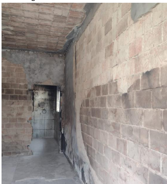
Figura 1 – Incêndio suíte PNR
