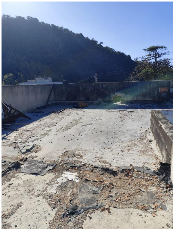
Foto 2 – Deterioração da laje
