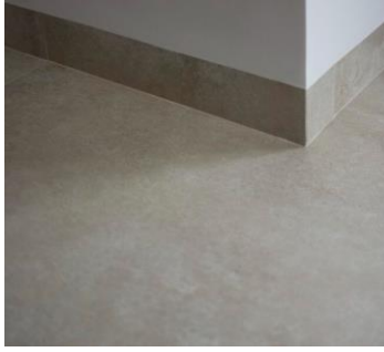
Foto 8 – Piso e rodapé porcelanato
