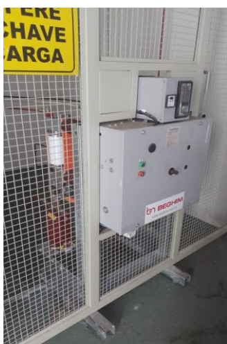
Figura 01 – Equipamento disjuntor de média tensão.
