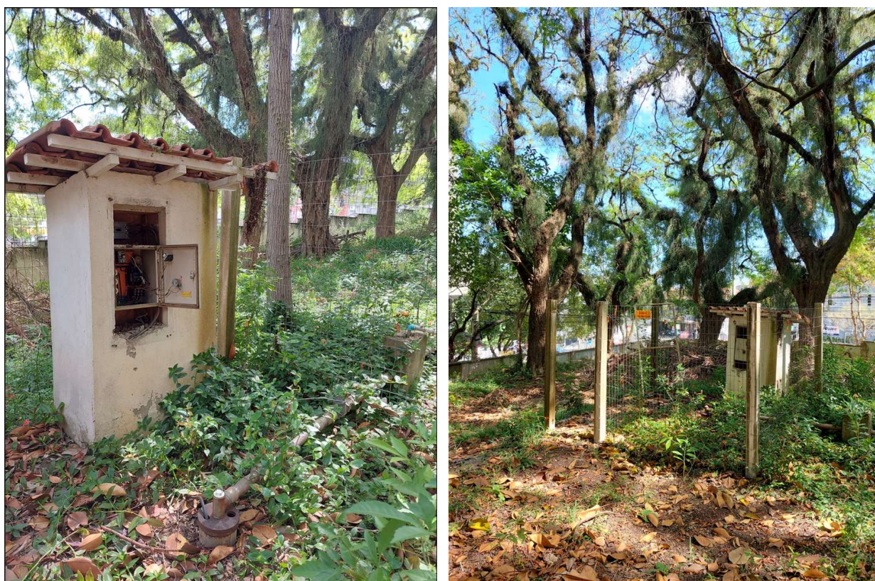
Figura 9. Imagens das instalações do poço tubular inativo, existente no HMAPA.
