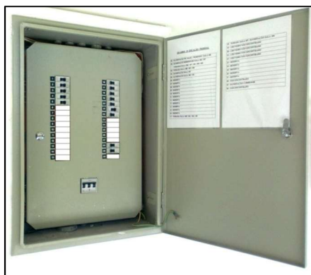
Figura 26 - Identificação dos disjuntores no quadro
