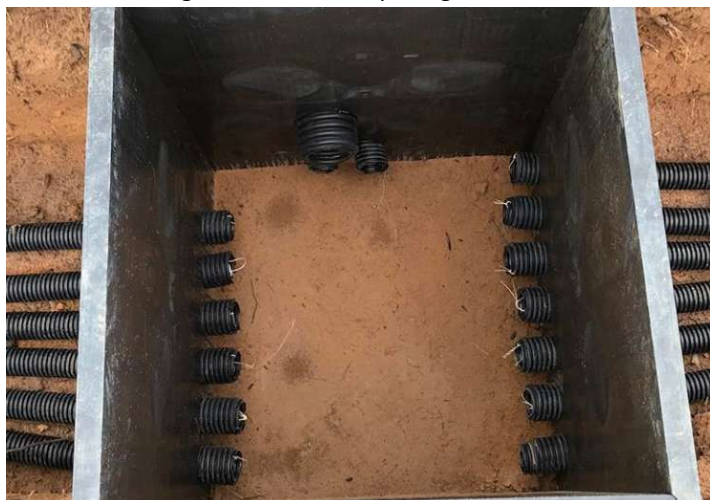
Figura 34 - Caixa de passagem
