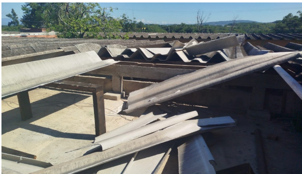
Fotografia 7 – Vista do telhado que necessita de reforma
