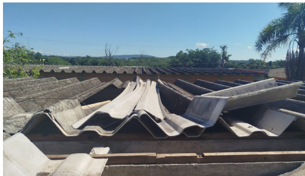
Fotografia 8– Vista do telhado que necessita de reforma
