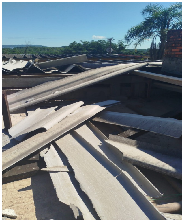
Fotografia 11 – Vista do telhado que necessita de reforma
