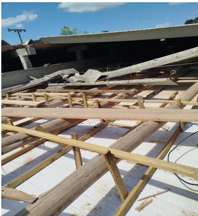
Fotografia 9 – Vista do telhado que necessita de reforma
