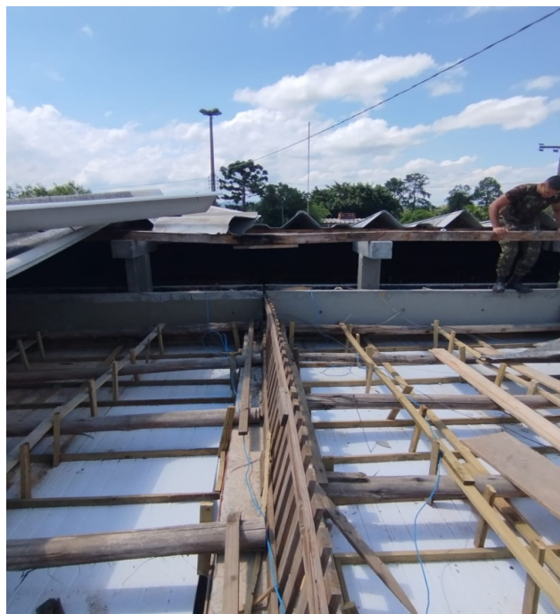
Fotografia 10 – Vista do telhado que necessita de reforma
