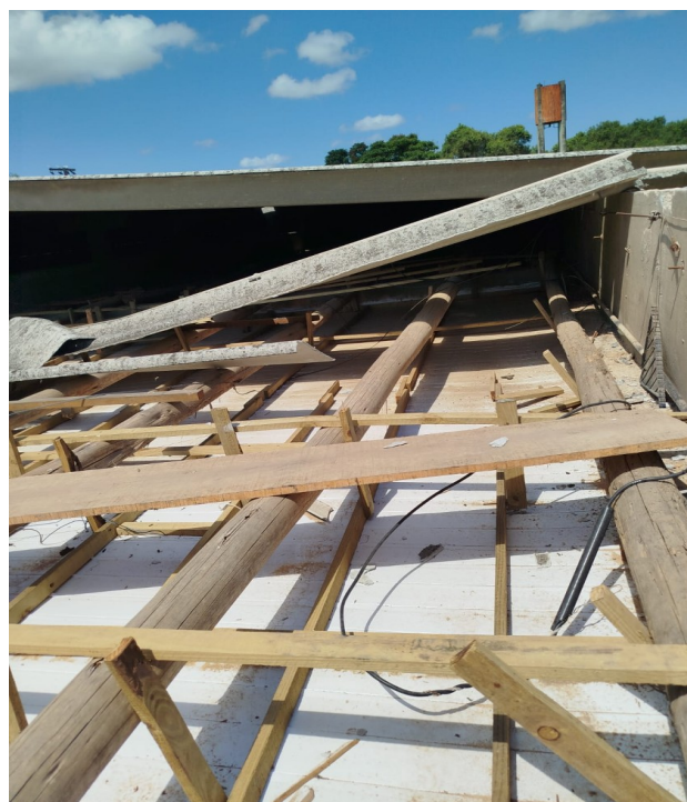
Fotografia 12 – Vista do telhado que necessita de reforma
