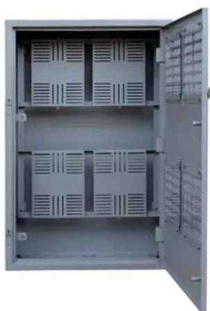
Foto 22: Quadro para 4 medidores
