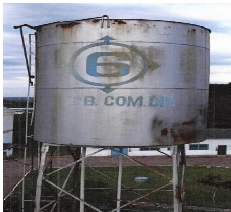
Imagem 7: atual reservatório metálico
