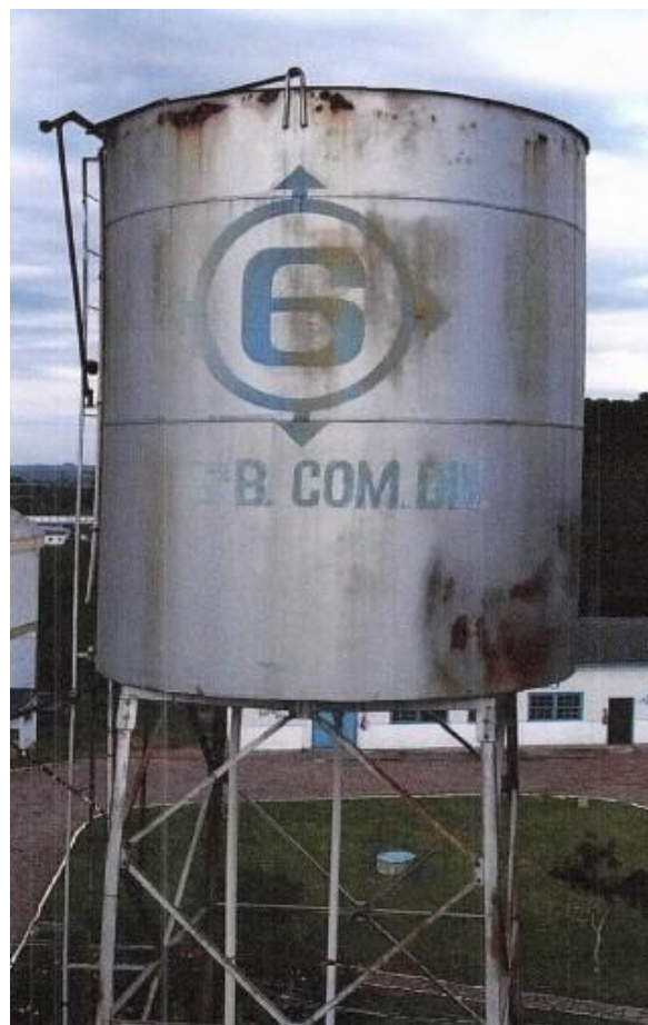
Imagem 2: atual reservatório metálico
