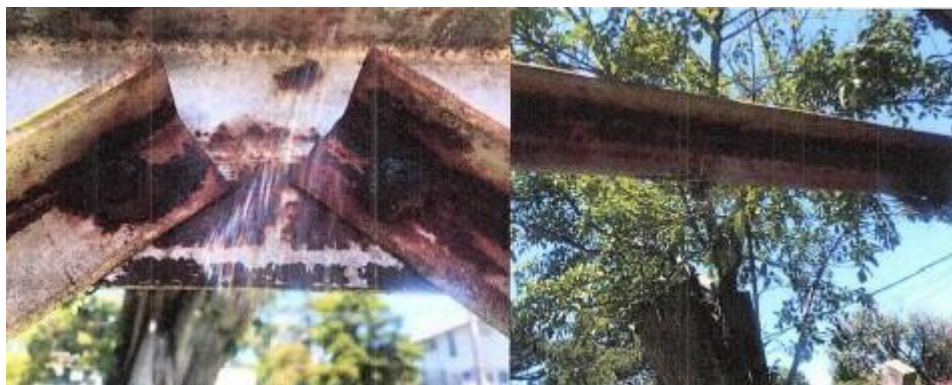
Imagem 5: oxidação da estrutura metálica
