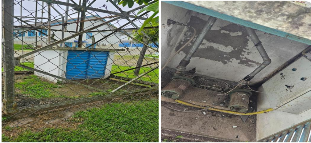
Imagem 8: casa de bombas
