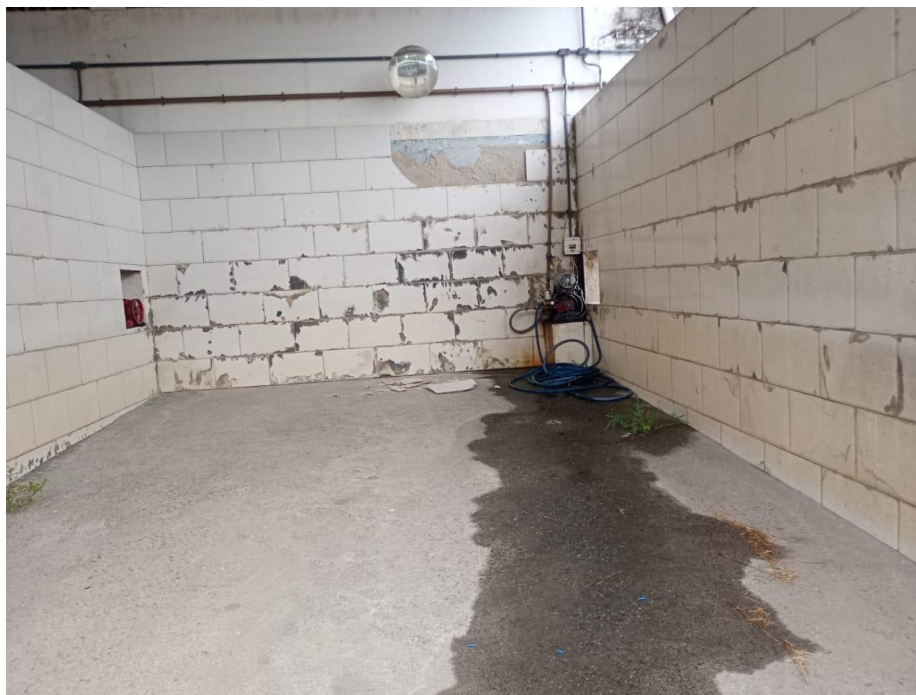
Foto 1 — Interior de um dos boxes do Posto de Lavagem de Leve
