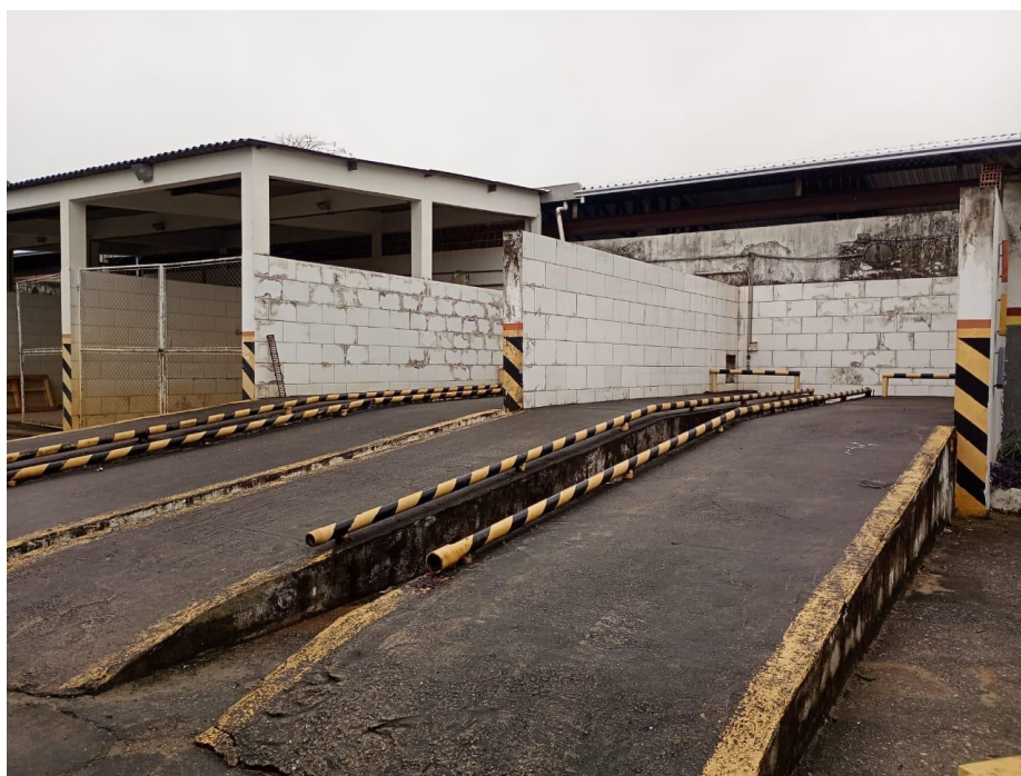
Foto 3 — Vista geral das rampas de lavagem
