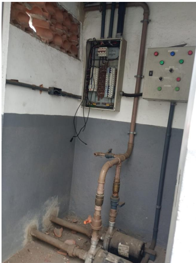
Foto 5 — Quadro elétrico e casa de bombas
