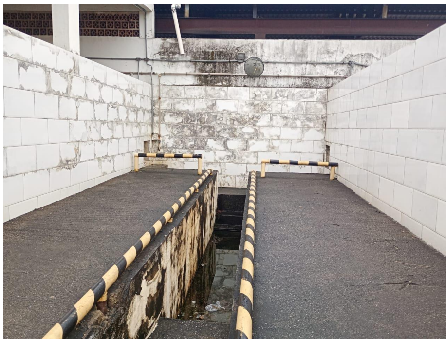
Foto 2 — Canaleta de drenagem entre as rampas
