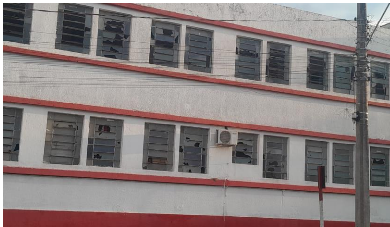
Figura 1 - Danos causados no sistema de cobertura e forro de alojamento da doma.
