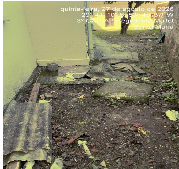
Figura 5 - Vista dos fundos da Capela: calçada a ser refeita
