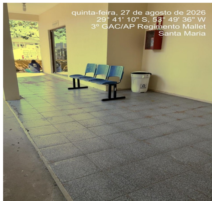
Figura 6 - Vista da frente da seção administrativa: piso cerâmico a ser substituído
