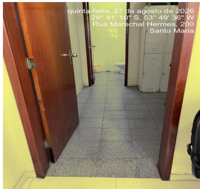
Figura 7 - Vista do banheiro da seção administrativa: piso cerâmico e portas a serem substituídos
