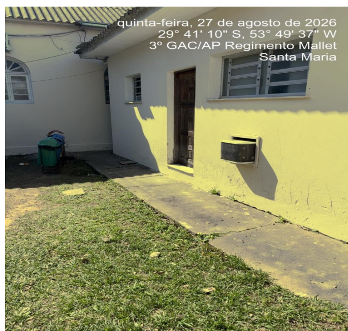
Figura 4 - Vista dos fundos da seção administrativa: calçada a ser refeita
