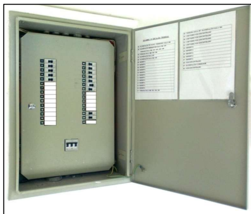
Figura 8 - Identificação dos disjuntores no quadro
