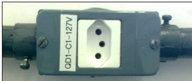
Figura 7 - Identificação tomada elétrica
