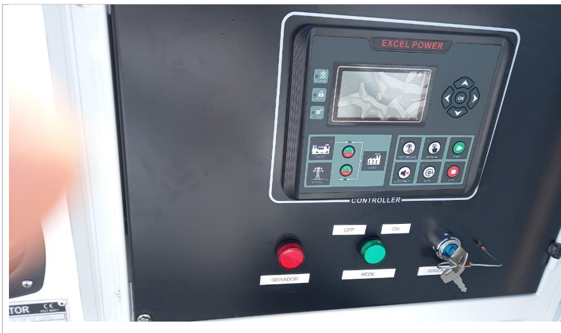
Figura 09 – Controlador do Gerador.
