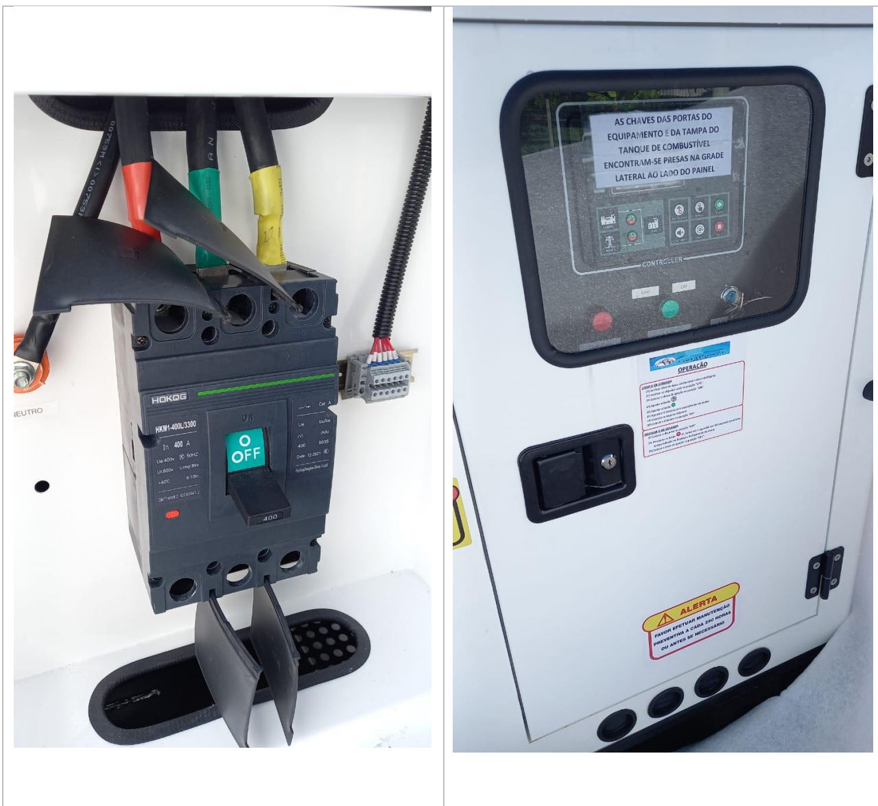
Figura 06 e 07 – Disjuntor de Proteção Gerador.
