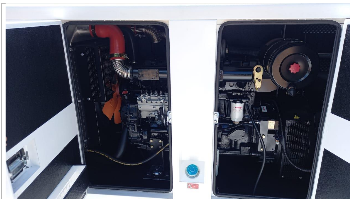
Figura 08 – Motor do Gerador.
