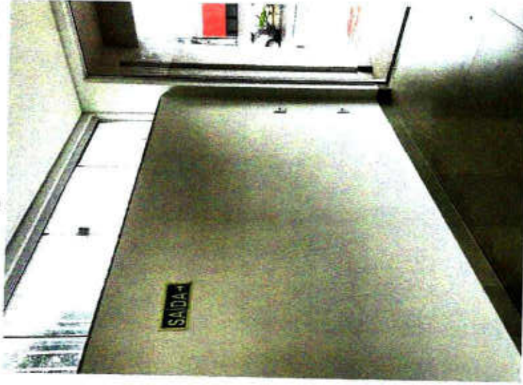
FOTO 19 – sinalização de saída
