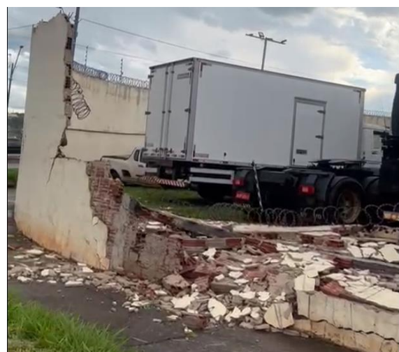
Figura 4 – Muro DMA Londrina – PR
