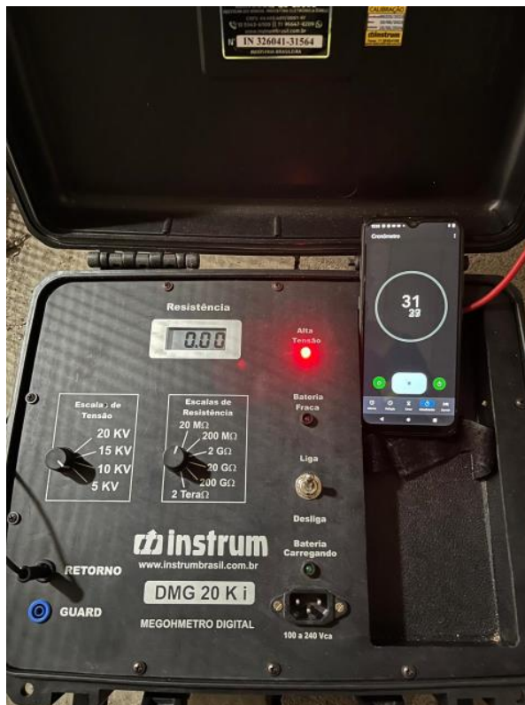
Ensaio cabo fase A (DANIFICADO)
