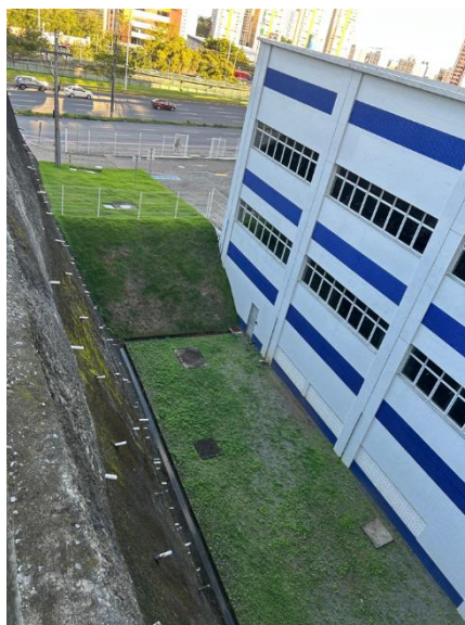
Fig. 1 Região lateral-direita do Edifício-Sede, com a presença das caixas de passagem e poços de visita.
