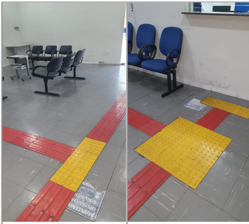
Sinalização do piso tátil em desconformidade com a NBR 16537:2024.
