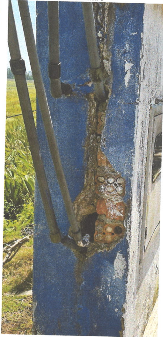
Entrada eletrodutos / mureta
