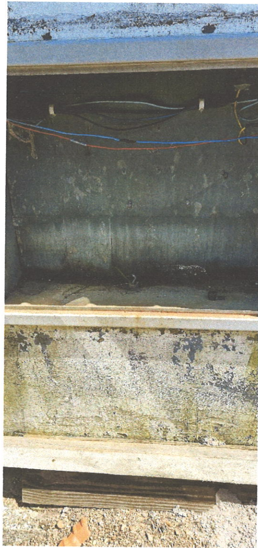
Passagem condutores / soltos
