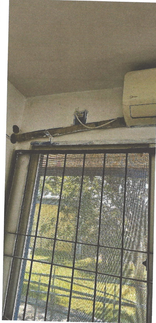
Tomada Ar condicionado / sem proteção / disjuntor
