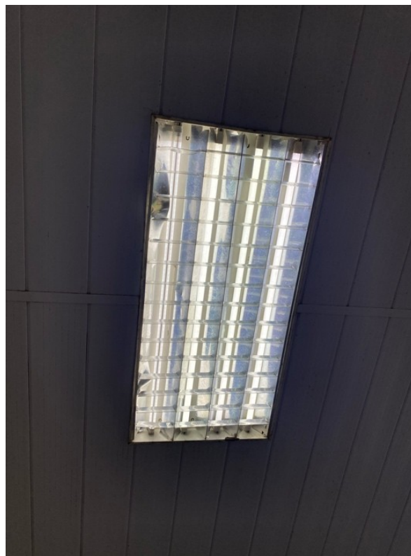
Figuras 06: Luminárias existentes.
