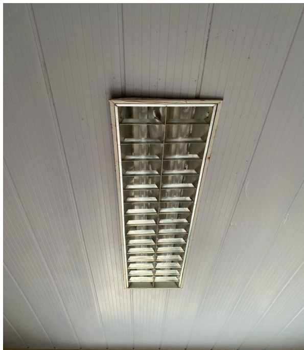
Figuras 04: Luminárias existentes.
