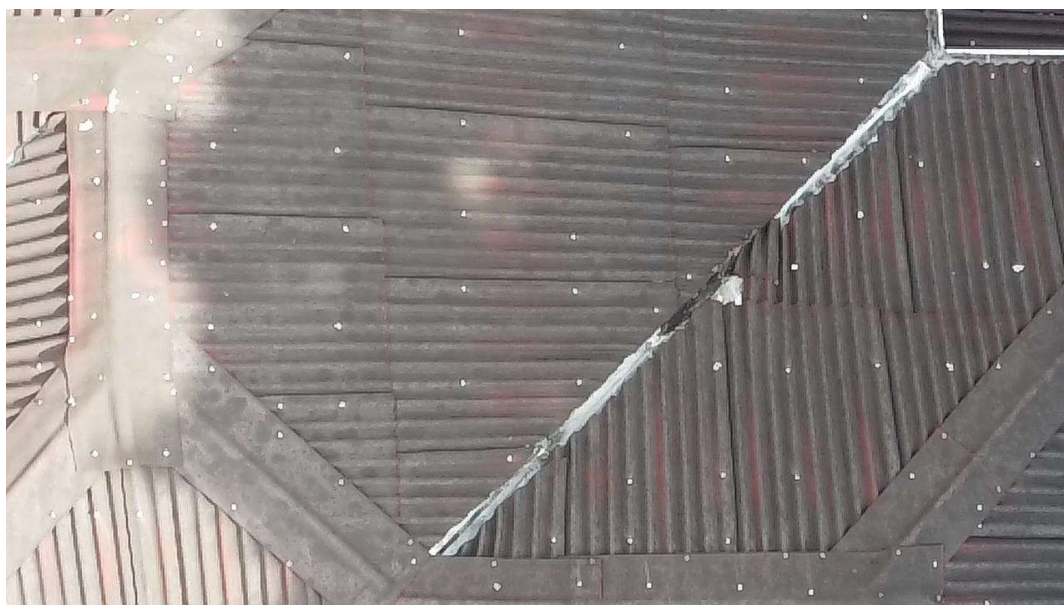
Foto 06 - Vista de panos e linhas de arremate
