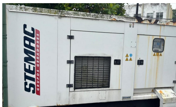
Figura 3 - Gerador tipo: N° 1026836118, N° Motor F1T046540, N° SITEMAC ST0260011515
