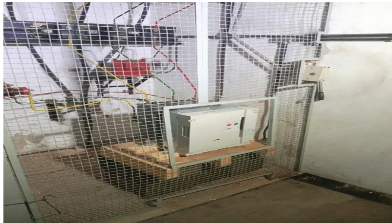
Figura 1 - Disjuntor conectado diretamente na linha, sem instrumentação de proteção e relé de proteção
