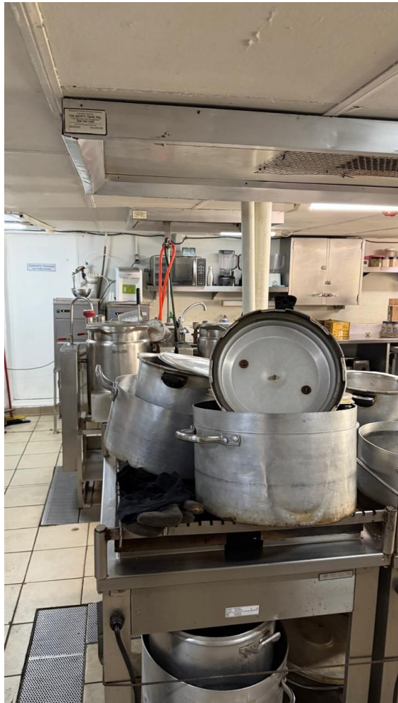
Foto 01 - Vista geral da cozinha e área central de preparo/cocção, evidenciando interferências de equipamentos, coifa e necessidade de melhor distribuição luminosa.
