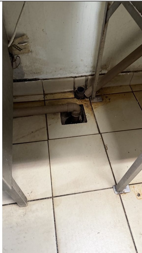
Foto 06 - Vista de corredor operacional da cozinha, com canaleta, água superficial e piso com juntas aparentes, exigindo melhor integração entre piso e drenagem.
