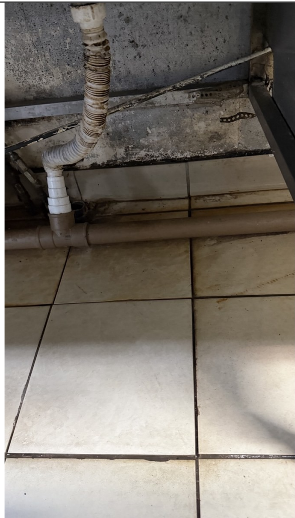
Foto 04 - Detalhe de tubulação e abertura junto ao piso, demonstrando necessidade de recomposição, nivelamento e acabamento sanitário adequado.
