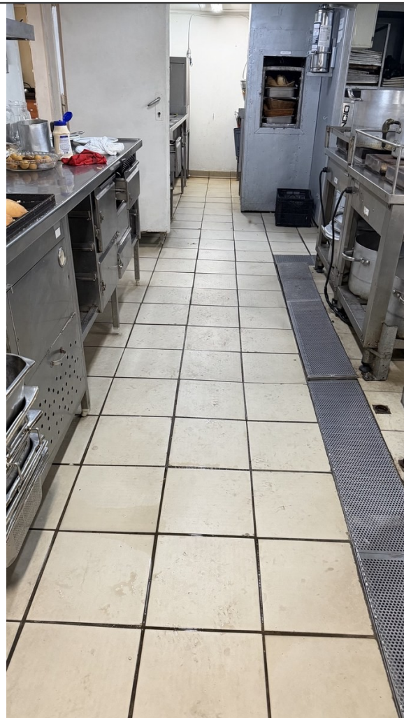
Foto 08 - Canaletas e grelhas na área de trabalho, demonstrando a necessidade de nivelamento, integração ao piso e facilidade de remoção/limpeza.
