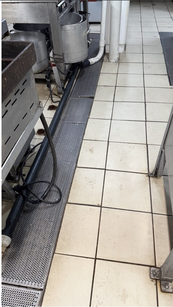
Foto 09 - Área de cocção e equipamentos térmicos com piso cerâmico antigo, juntas aparentes e pontos de sujidade, exigindo recuperação para melhor apresentação sanitária.
