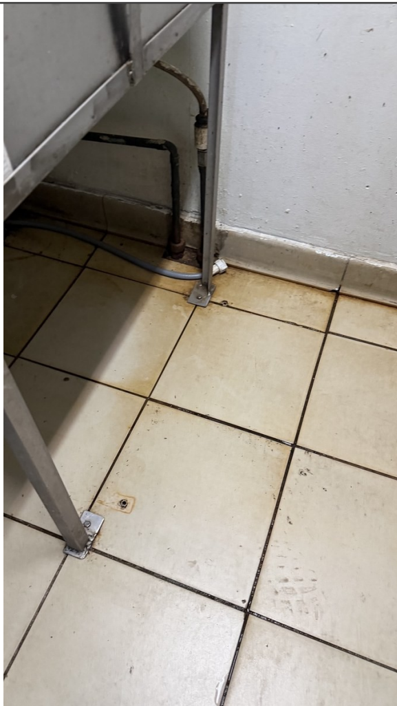
Foto 05 - Encontro de tubulação, parede e piso com frestas e sujeidade impregnada, indicando pontos potenciais de acúmulo de gordura e umidade.
