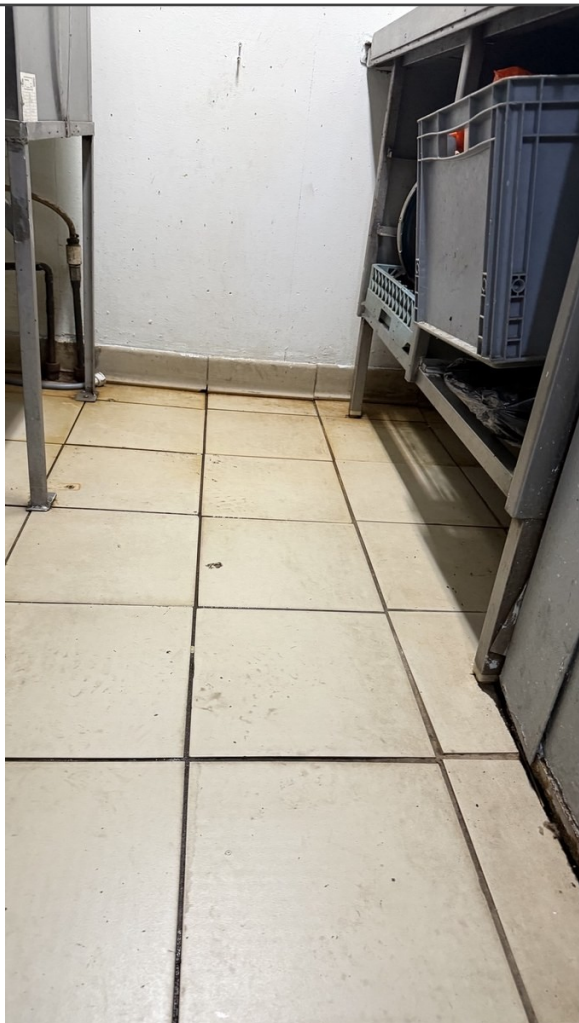
Foto 01 - Vista geral do piso na área de circulação, evidenciando placas cerâmicas com juntas extensas, marcas de uso e necessidade de acabamento sanitário mais uniforme.
