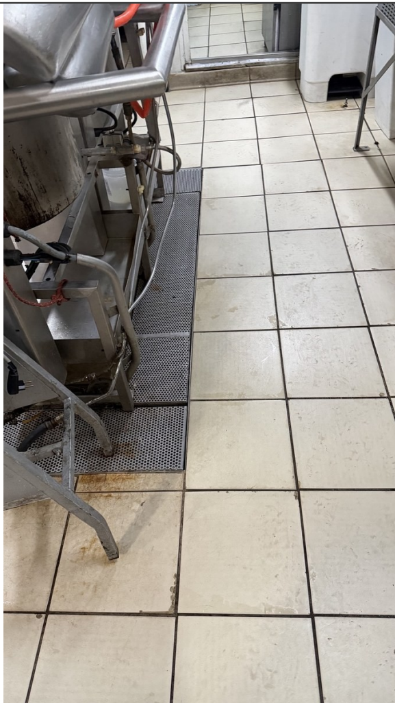
Foto 03 - Trecho com canaleta/grelha e presença de umidade superficial, reforçando a necessidade de melhoria do caimento e do escoamento.
