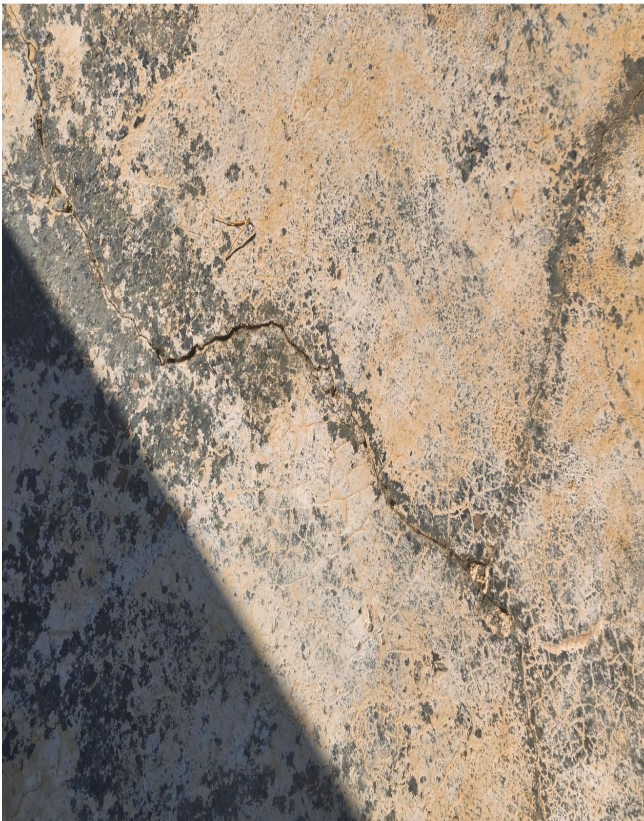
Figura 9: IMAGEM PARCIAL DAS FISSURAS DO PISO DA VARANDA DO FAROL - SERVIÇO DE TRATAMENTO DA SUPERFÍCIE EM ALVENARIA COM APLICAÇÃO DE PRODUTOS ELASTOMÉRICOS NECESSÁRIOS A IMPERMEABILIZAÇÃO
