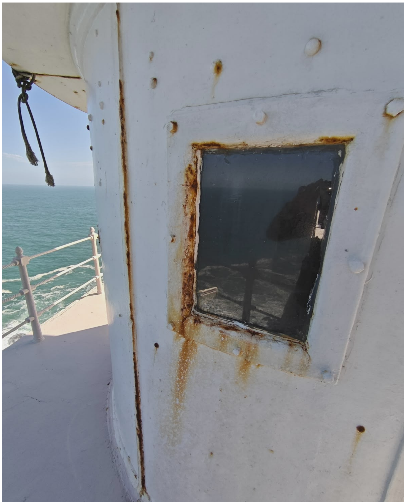
Figura 7: IMAGEM PARCIAL DO EXTERIOR DA CÚPULA - SERVIÇO DE REMOÇÃO DA TINTA ANTIGA, FERRUGEM E CONTAMINANTES, TRATAMENTO ANTICORROSIVO E APLICAÇÃO DE TINTA
