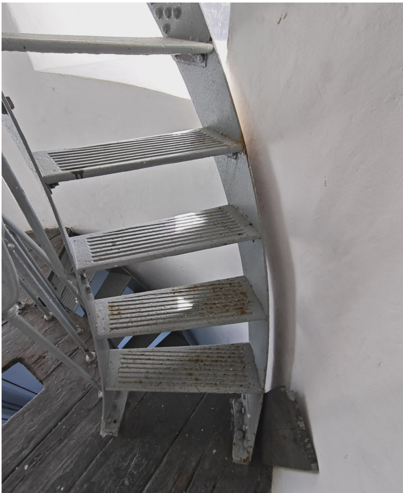
Figura 12: IMAGEM DA ESCADA DE ACESSO DO MEZANINO PARA CÚPULA - SERVIÇO DE REMOÇÃO DA TINTA ANTIGA, FERRUGEM E CONTAMINANTES, TRATAMENTO ANTICORROSIVO E APLICAÇÃO DE TINTA
