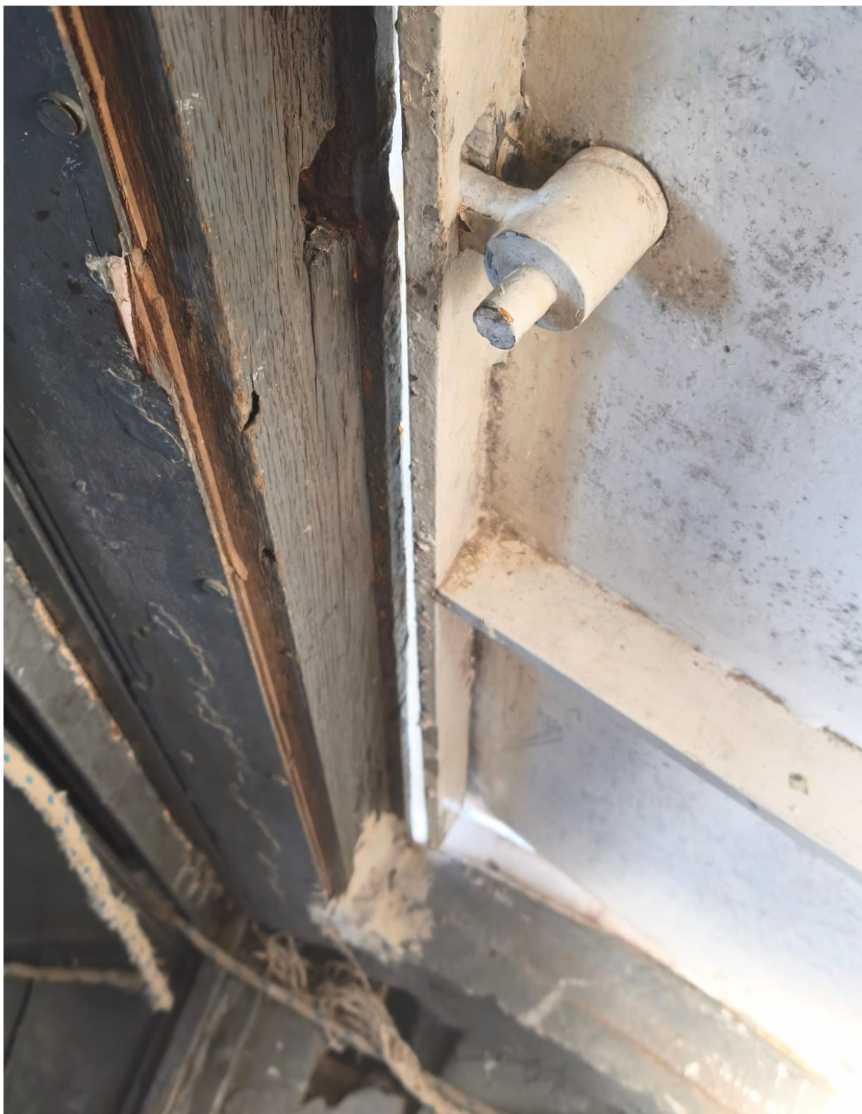
Figura 17: IMAGEM DA PORTA DE ACESSO DA CÚPULA PARA A VARANDA – SERVIÇO DE INSTALAÇÃO DE DISPOSITIVO DE TRAVAMENTO E FECHAMENTO MECÂNICO DO TIPO PRESSÃO, REMOÇÃO DA TINTA ANTIGA, FERRUGEM E CONTAMINANTES, TRATAMENTO ANTICORROSIVO E APLICAÇÃO DE TINTA
