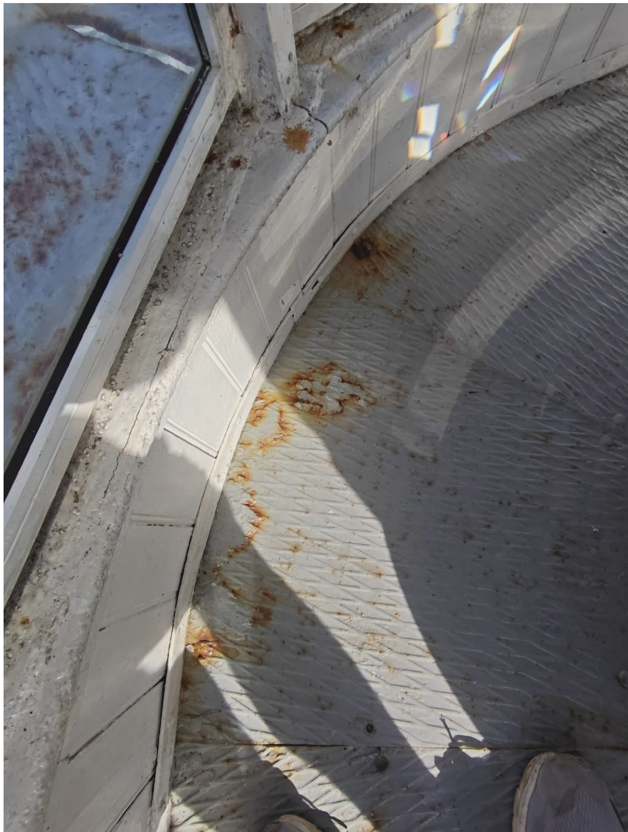
Figura 5: FOTO DO PISO SUPERIOR DA CÚPULA E DA BASE DAS COLUNAS DAS VIDRAÇAS – SERVIÇO DE REMOÇÃO DA TINTA ANTIGA, FERRUGEM E CONTAMINANTES, TRATAMENTO ANTICORROSIVO E APLICAÇÃO DE TINTA
