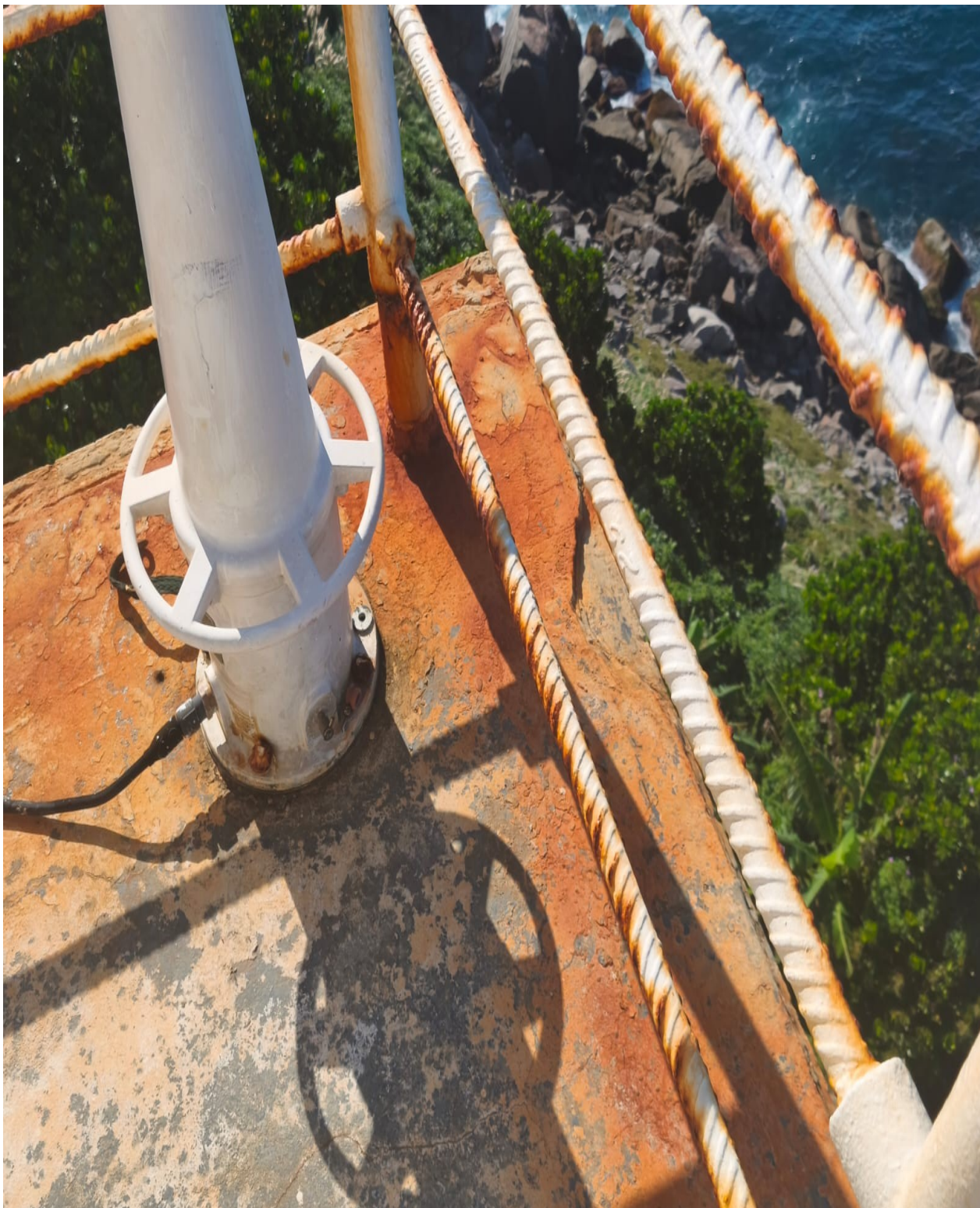
Figura 11: IMAGEM PARCIAL DO GUARDA CORPO DO FAROL - SERVIÇO DE REMOÇÃO DA TINTA ANTIGA, FERRUGEM E CONTAMINANTES, TRATAMENTO ANTICORROSIVO E APLICAÇÃO DE TINTA
