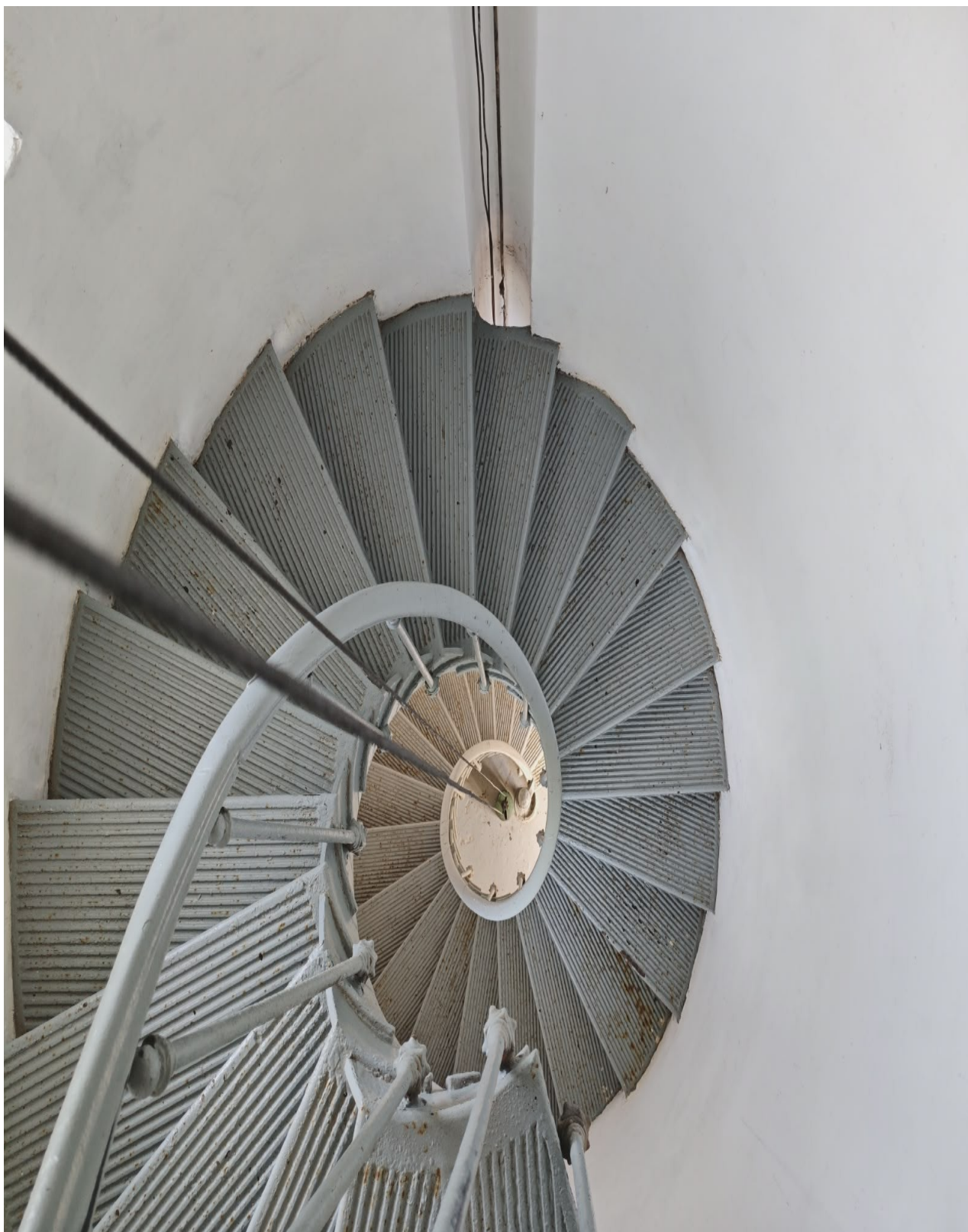
Figura 2:IMAGEM DA ESCADARIA DO FAROL, VISTA DE CIMA - SERVIÇO DE REMOÇÃO DA TINTA ANTIGA, FERRUGEM E CONTAMINANTES, TRATAMENTO ANTICORROSIVO E APLICAÇÃO DE TINTA
