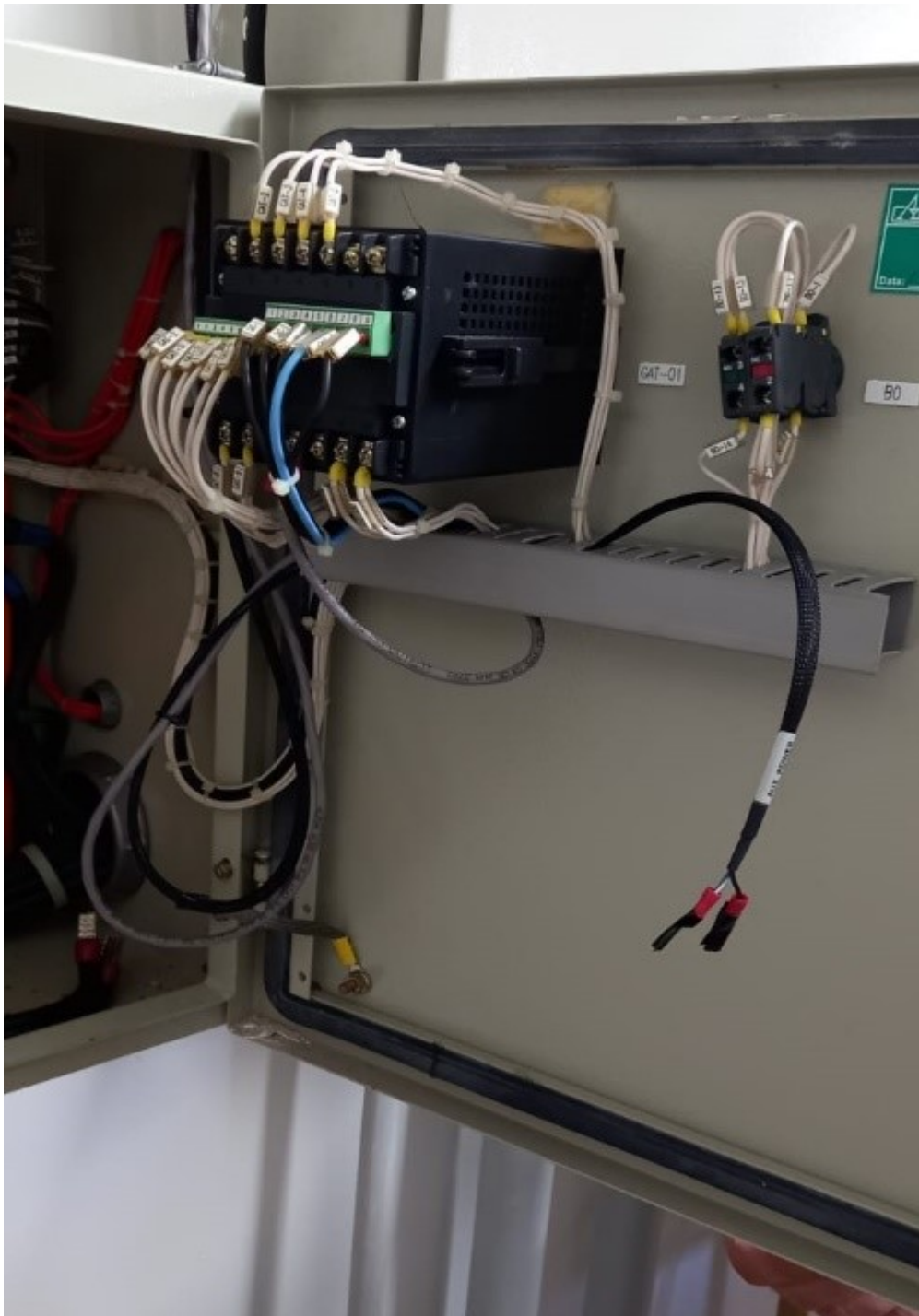
Foto 3 – Parte interna Fundos painel do Quadro:
