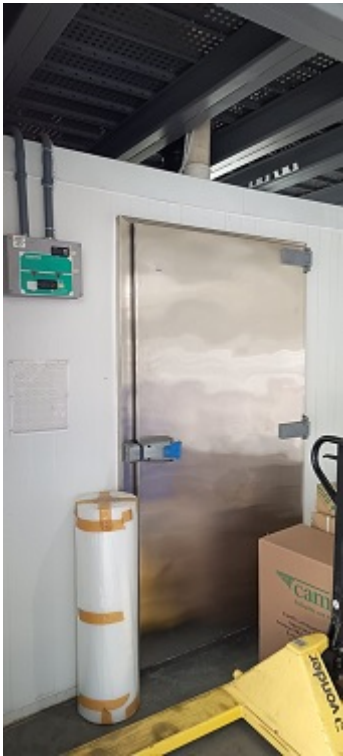
Figura 01 - Câmara frigorífica almoxarifado
