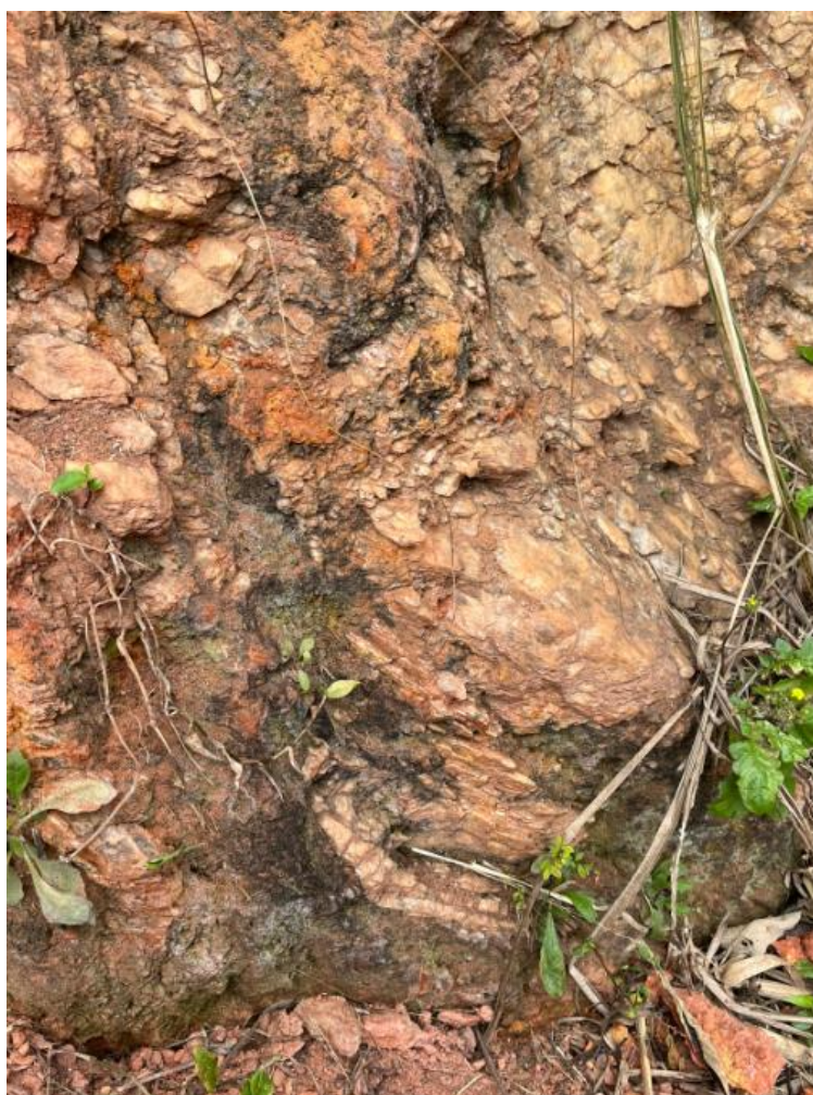
Figura 20 - Saprólito de rocha granito-gnaissica na base do talude.
