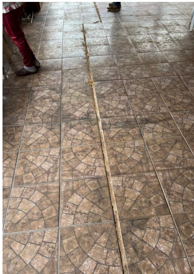
Figura 37 – Patologias estruturais presentes no topo do talude.
