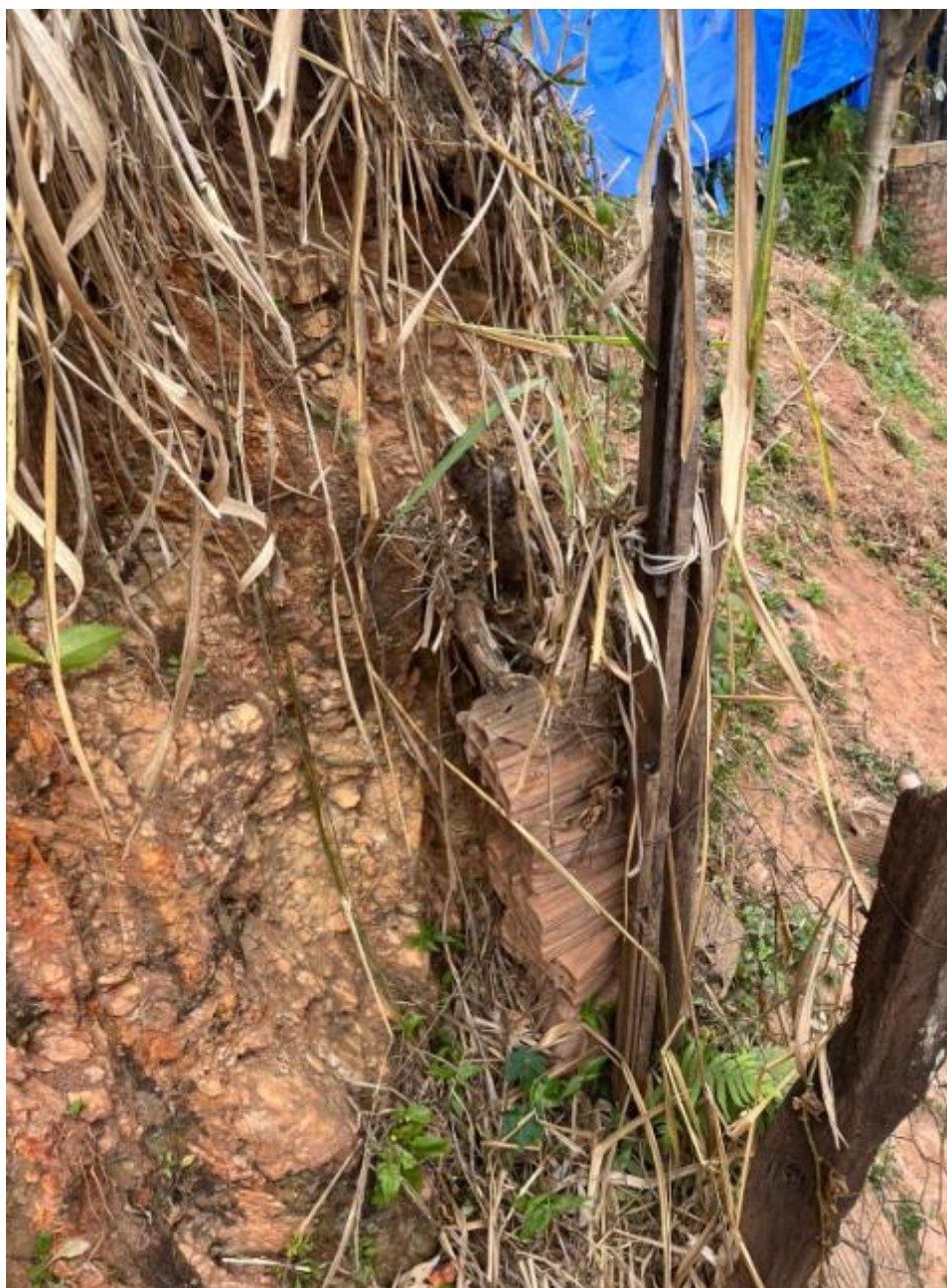
Figura 18 - Fotografia de solo silto-argiloso na base do talude.
