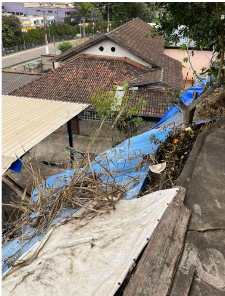
Figura 19 – Ausência de estruturas de drenagem no topo do talude.
