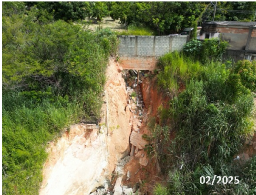
Imagem 3: erosão no talude do túnel, vista de frente. Visão do muro da rua Marcelino Ferreira sem apoio na base (risco iminente de desabamento).
