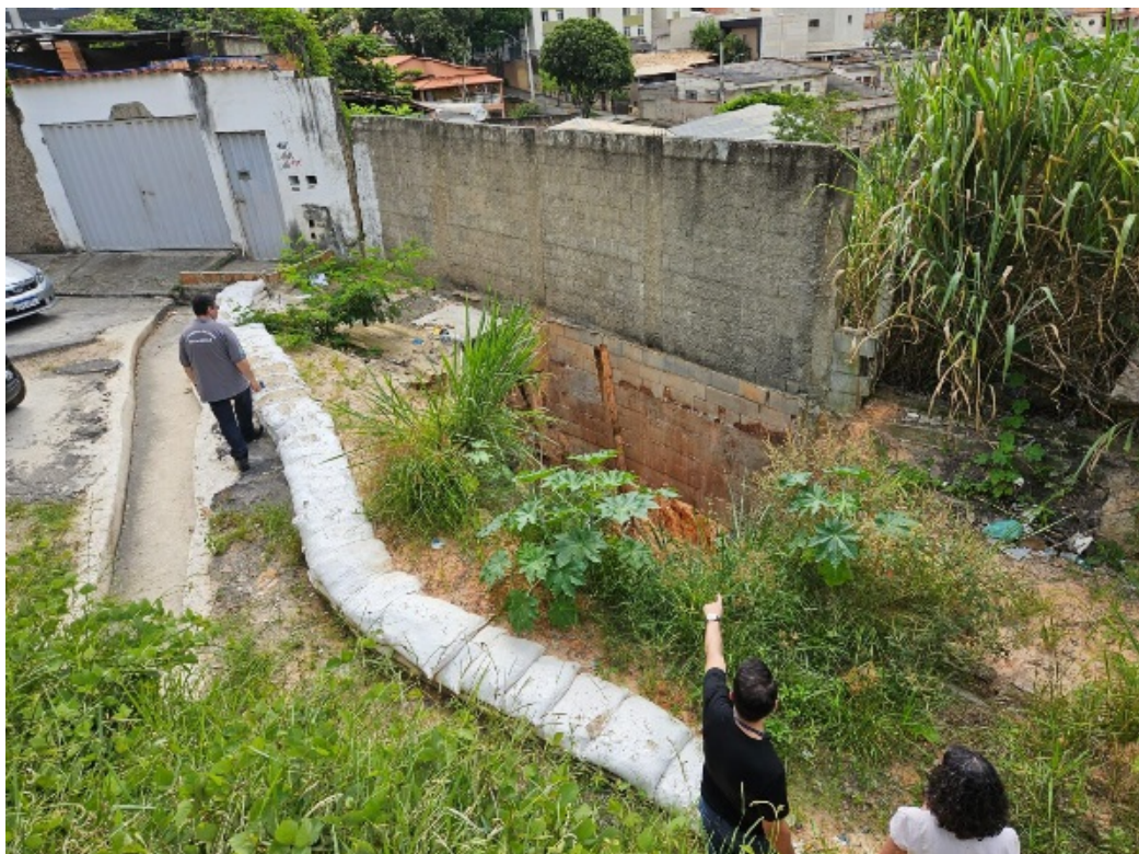
Imagem 7: erosão na base do muro localizado no final da rua Marcelino Ferreira (risco iminente de desabamento). Canaleta e sacos para desvio da água. Fev/2025
