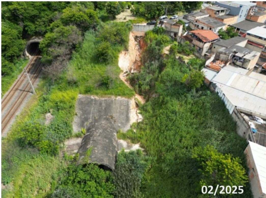
Imagem 4: vista de frente da erosão no talude do túnel desativado, com casas à direita e trilho/túnel do metro da Estação José Cândido da Silveira à esquerda da foto.
