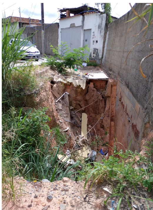
Imagem 8: erosão na base do muro localizado no final da rua Marcelino Ferreira (risco iminente de desabamento).
