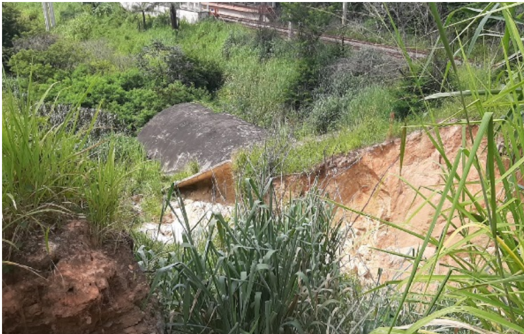
Imagem 10: erosão no talude do túnel desativado
