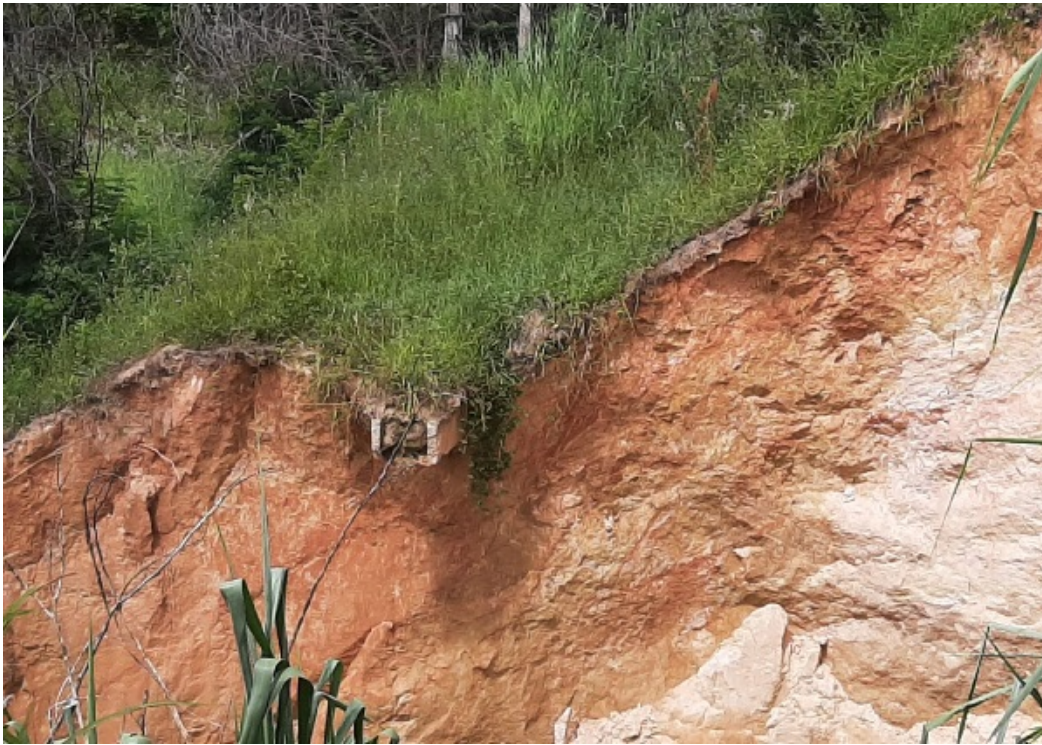
Imagem 9: erosão no talude do túnel desativado com dispositivo de drenagem rompido e obstruído
