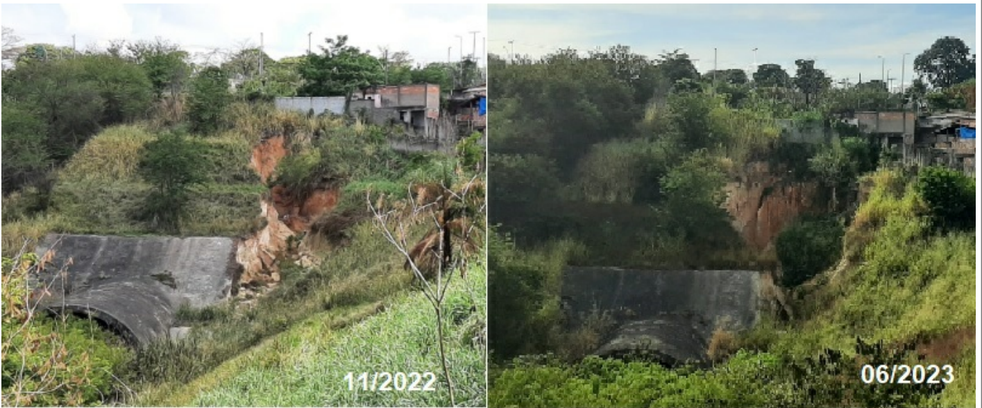
Imagem 2: erosão no talude do túnel, vista de frente. Comparação entre novembro/2022 e junho/2023.
