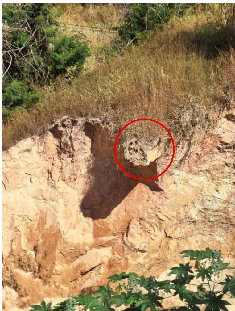
Figura 17 – Parede exposta do talude silto-argiloso com presença de canaleta entupida e em péssimo estado de conservação.
