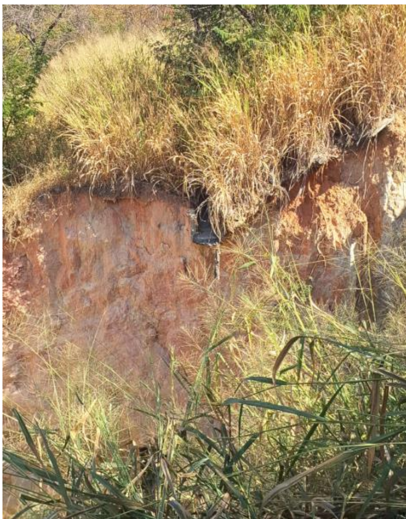
Figura 31 – Ilustração de canaleta quebrada e parcialmente obstruída.
