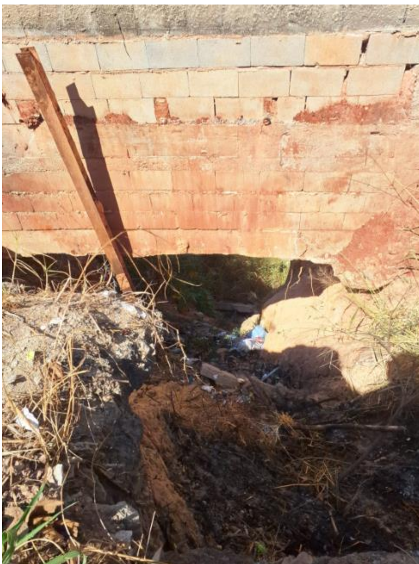
Figura 16 – Crista do talude, com evidências de movimentação ativa do terreno e desmoronamento.
