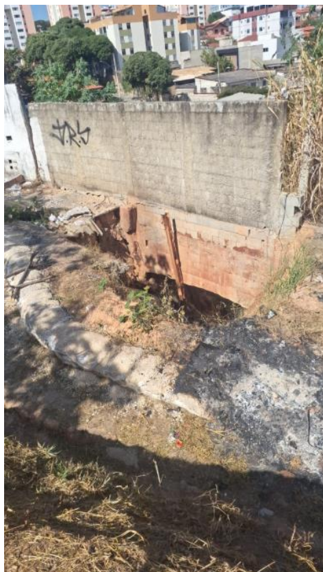
Figura 34 – Topo do talude e muro de concreto. Ausência de estruturas de drenagem, escorregamento ativo de material antrópico e declividade acentuada.
