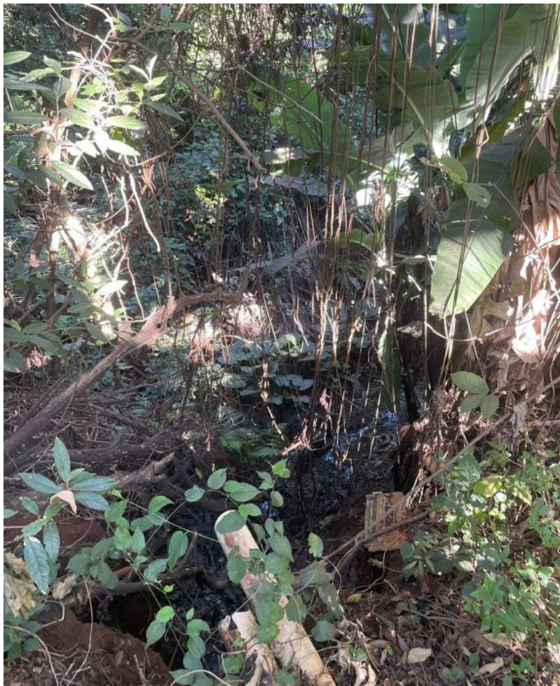
Figura 23 – Drenagem efêmera e água de esgoto escoando pela superfície do terreno.
