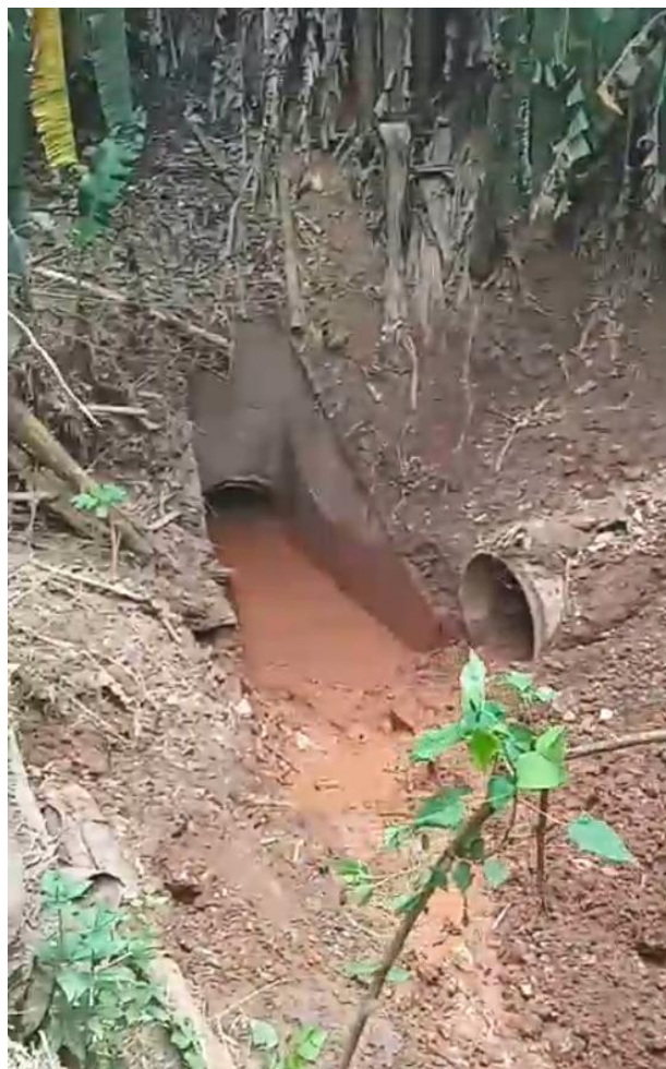
Figura 24 - Local onde recomenda-se o fechamento da drenagem aberta com caixa de concreto e continuidade do manilhamento até os limites do terreno da união. Após a instalação de tal sistema será possível realizar a limpeza e o aterramento do pé do talude gerando estabilidade geotécnica.
