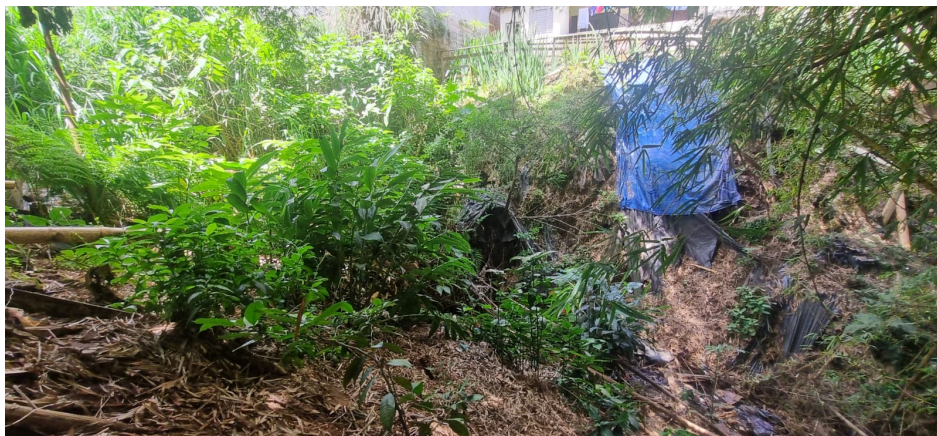
Figura 13 (a e b): Residências construídas acima da erosão (fora da área de propriedade da União), com lonas nas encostas e tubos de esgoto lançando a céu aberto.
