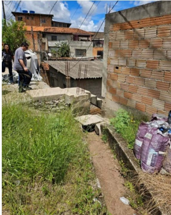
Figura 10 - Drenagem da Rua Adriano Chaves Matos que é lançada na área da erosão
