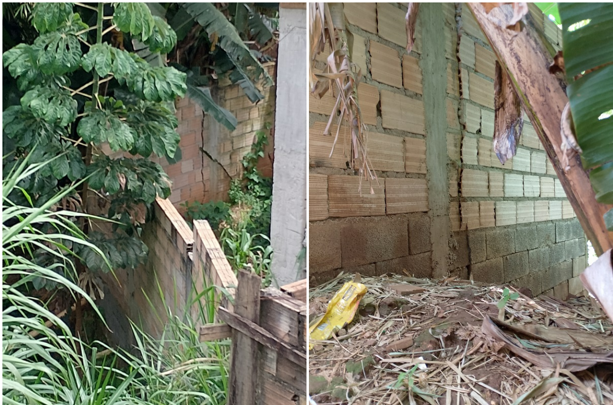
Figura 14 (a e b): Muro de uma das residências ( fora da área de propriedade da União) acima da erosão, apresentando deslocamento e fissura com separação
