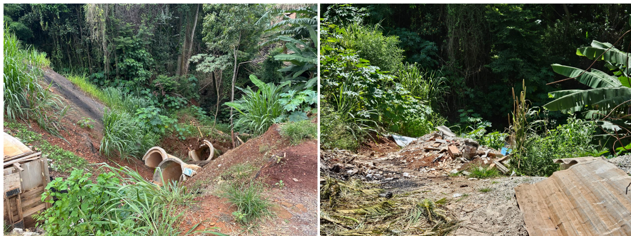
Figura 4: Área da erosão contendo manilhas de concreto soltas (esq. 2024) e aterro com entulhos (dir. 2025)
