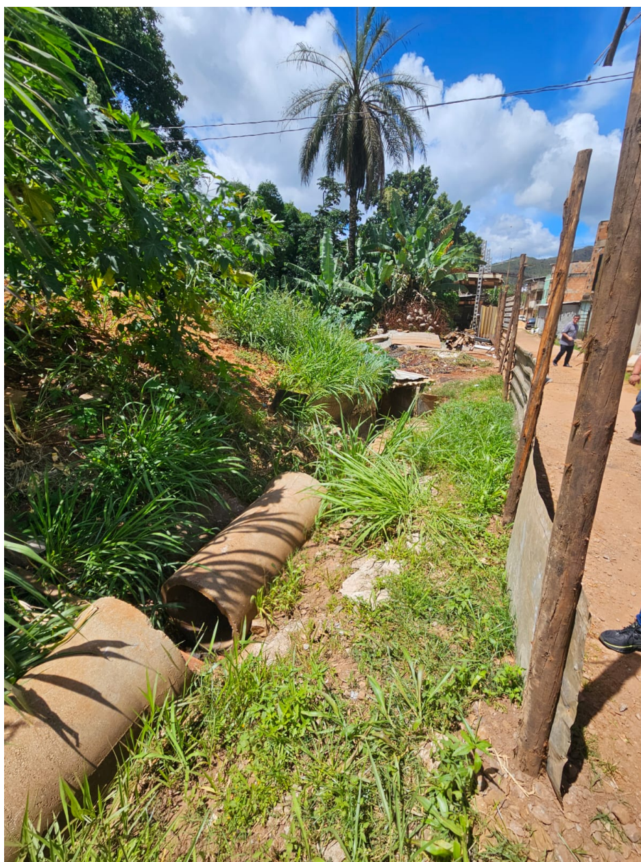
Figura 5: Obra de drenagem inacabada, manilhas de concreto danificadas e não conectadas.
