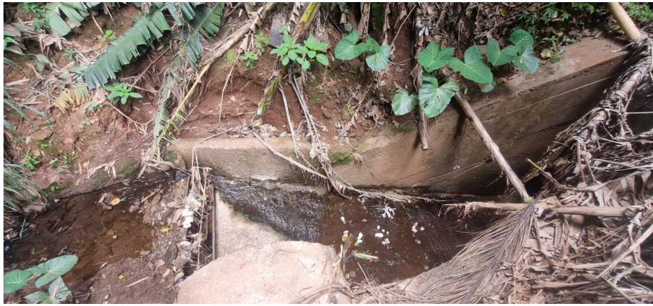
Figura 9 (a e b): Órgão de drenagem no fundo do talvegue, passa sob a antiga ferrovia, provavelmente implantado pela RFFSA
