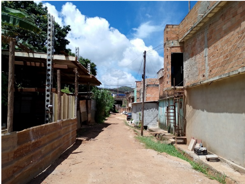
Figura 7: Rua ao lado da região da erosão. Faz parte da área do imóvel da união.
