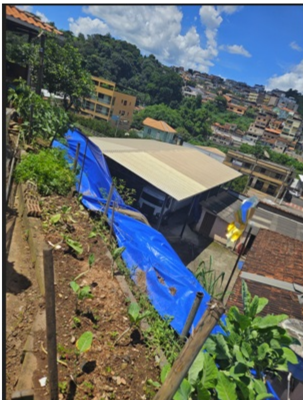
Figura 4: vista lateral direita da encosta e residências abaixo do talude. Lonas doadas pela SPU-MG instaladas.
