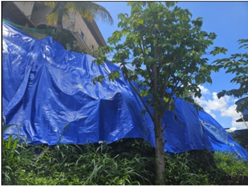
Figura 6: vista debaixo do talude, da residência do Sr. Murilio, da extinta RFFSA. Lonas doadas pela SPU-MG instaladas.
